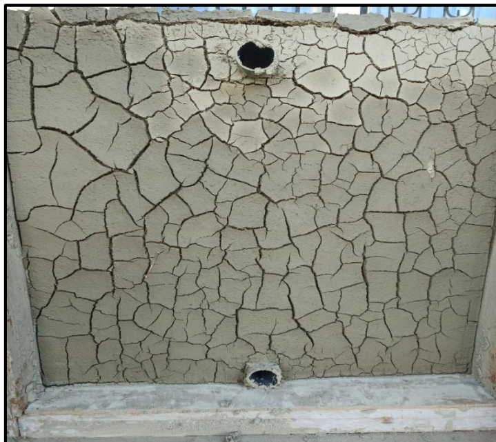
Figure I.10 : les fissures sur la paroi extérieure du mur argile
