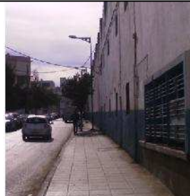
Figure 92 : Image d'un trottoir état dégradé Source : Auteur
