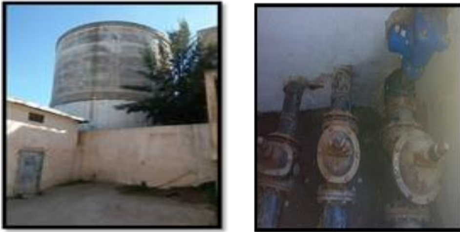
Figure (III.3) : Vue extérieure du réservoir de Bousahel et la chambre de vanne
