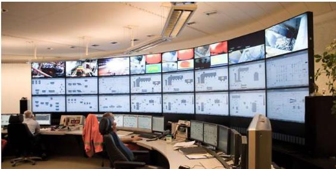
Figure III-3: Salle de contrôle.[41]
