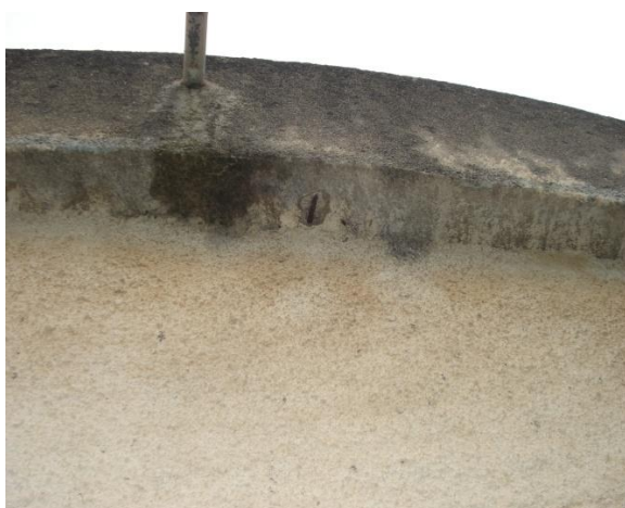
Figure 1.5: Eclatement de l'enduit d'enrobage des aciers.
