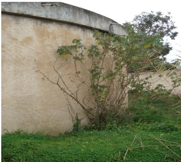
Figure 1.10: Présence de végétation autour du réservoir.
