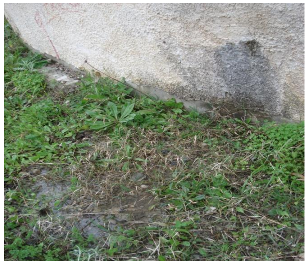
Figure 1.11: Fuite au niveau de la paroi du réservoir.
