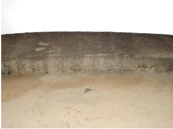
Figure 1.7 : Ecaillage sous la ceinture supérieure du réservoir Touaressse 1965.
