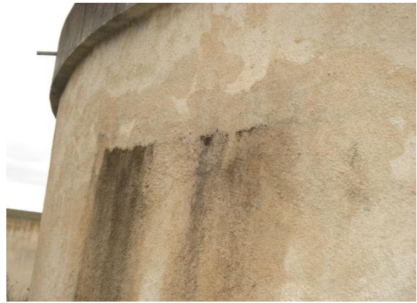
Figure 1.8 : Fissure horizontale sur la paroi du réservoir Touaressse 1965.
