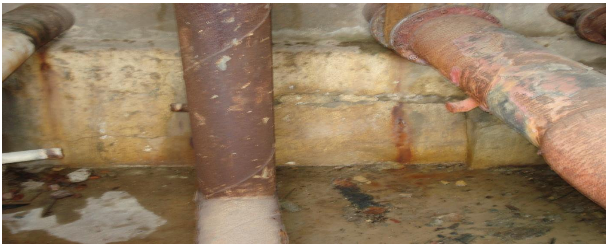
Figure 1.9 : Fissure et suintement au niveau du radier.
