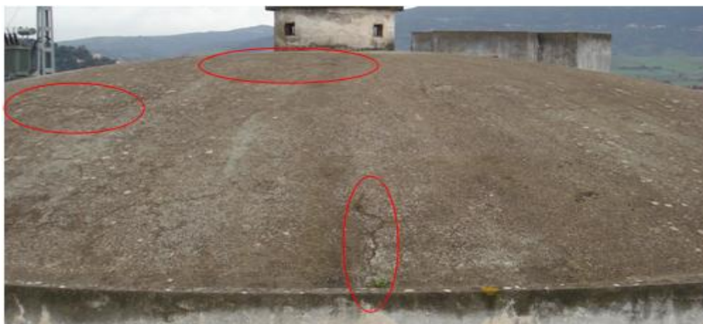
Figure 1.2 : Fissure et trou sur la couverture.
