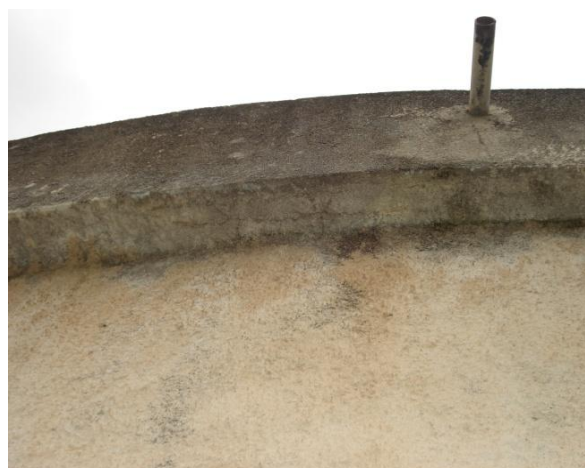
Figure 1.6 : Eclatement de l'enduit d'enrobage et fissure horizontale dans la paroi sous la ceinture supérieure.
