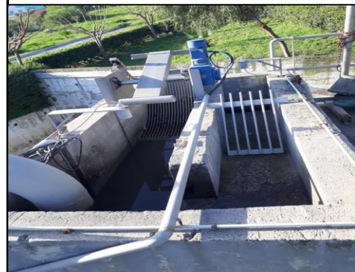
Figure 3 : Dégrilleur fin courbe automatique
