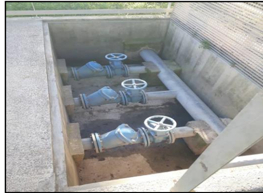
Figure 2 : Poste de relevage
