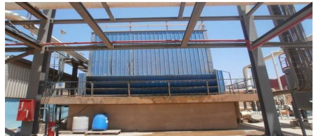
Tour de refroidissement
