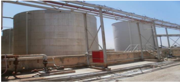
Bac de stockage calorifugé 200m 3 du silicate (la température de stockage est de 50°C)
