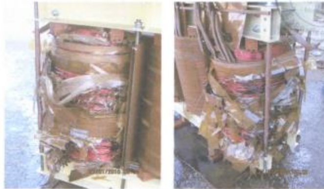
PHOTOS N°5 et N°6 : bobinage gonflé
