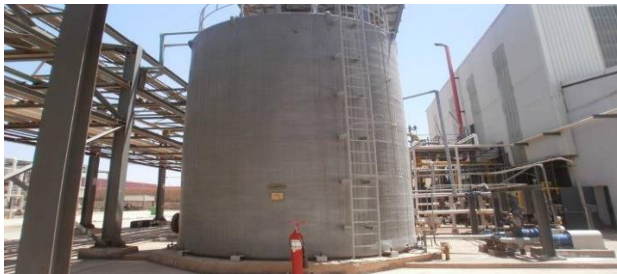
Bac de stockage de la saumure pure
