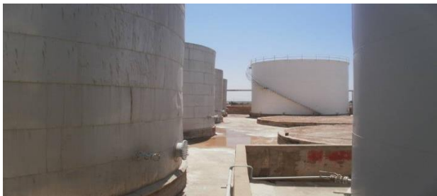
Bac d'eau traitée 1 000 m 3
