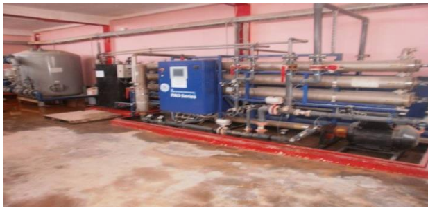
Station osmose inverse « PROSERIES »
