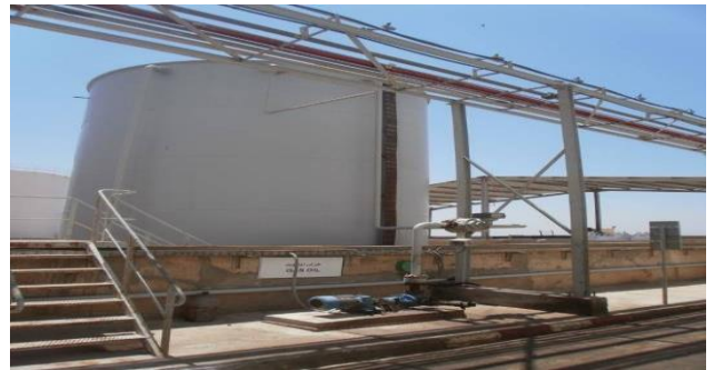
Bac de gasoil
