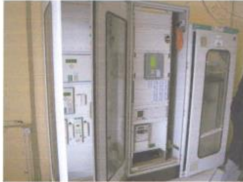
PHOTOS N°9 : vue sur l'armoire électrique endommagée
