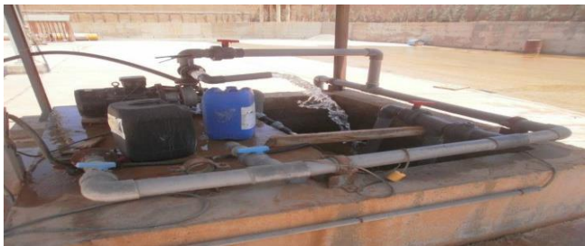
Evacuation des eaux condensats
