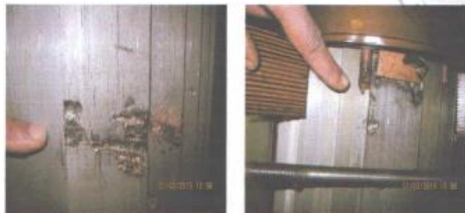
PHOTOS N°7 et N°8 : colonne V et W endommagés
