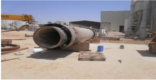
Four de séchage du sable en maintenance
