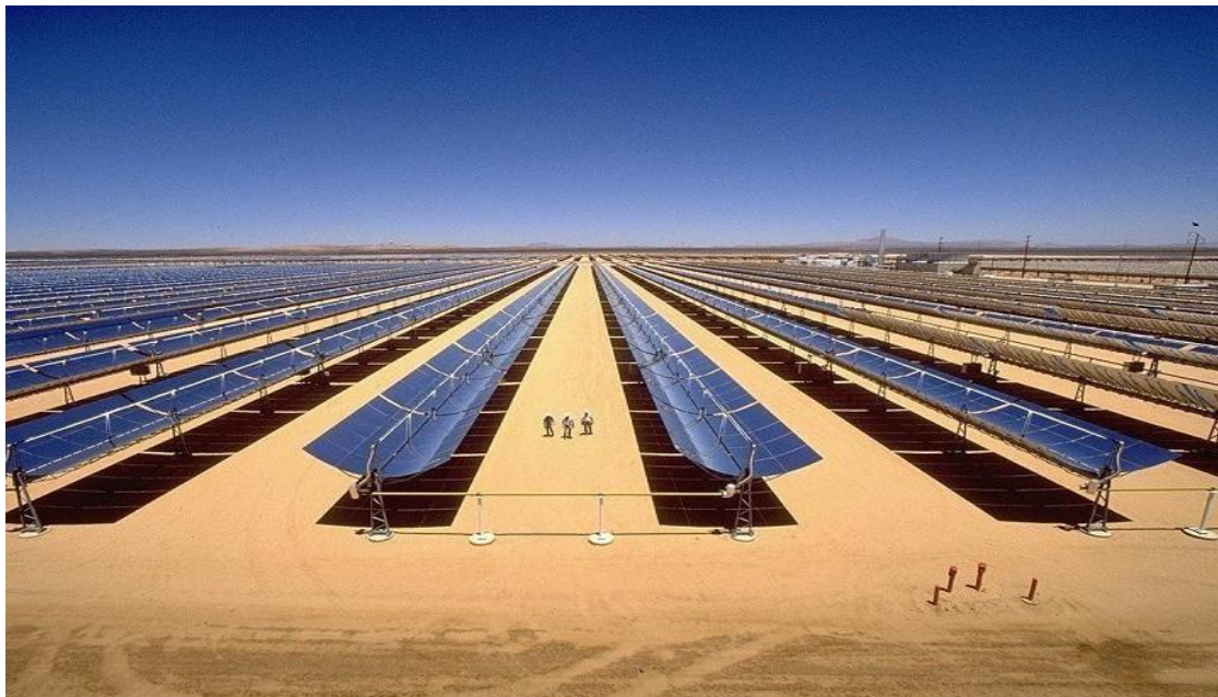
Figure I-22. Centrale à capteurs cylindro-parabolique. [29]
