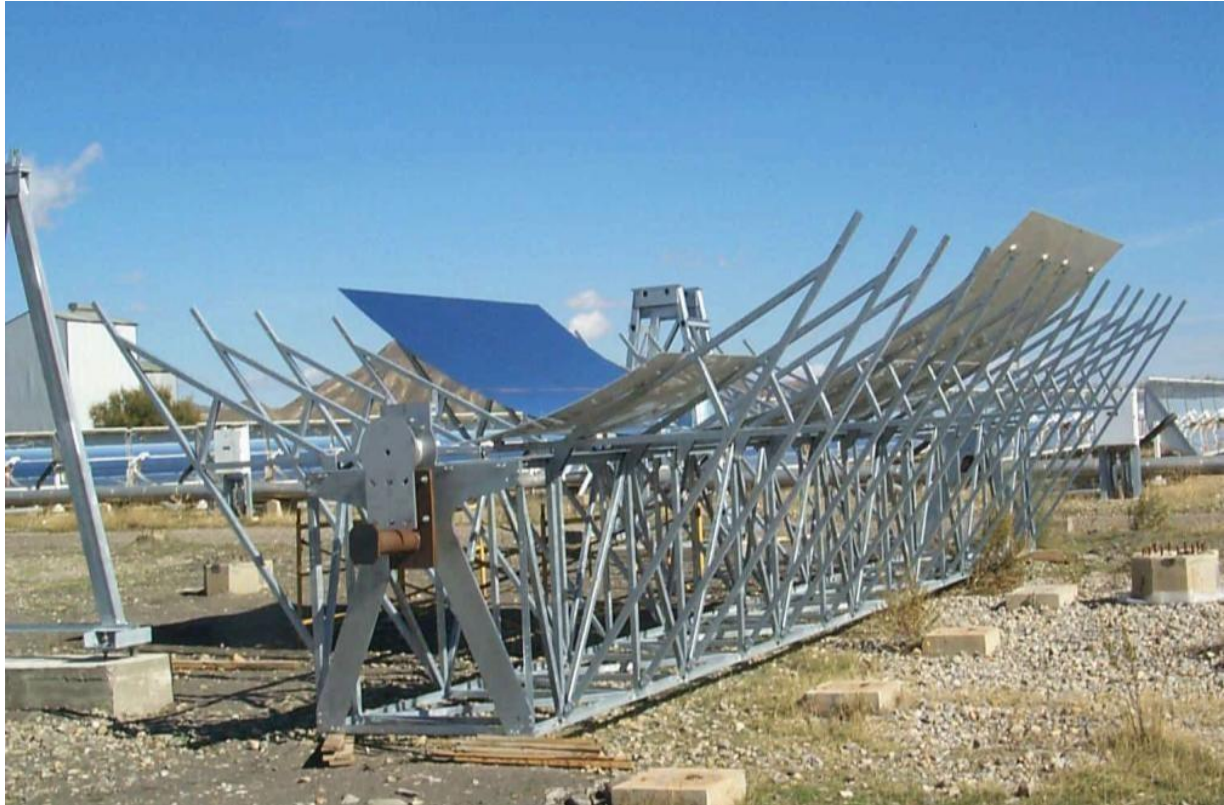
Figure II-15. Structure métallique d'un concentrateur cylindro parabolique.
