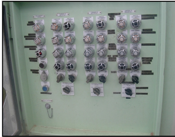
Figure III.2 : Vue du panneau de commande local du démarrage du régénérateur H301
