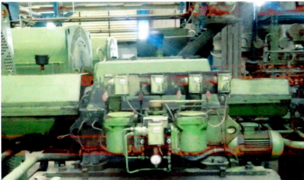
Figure II.10 : photo de la pompe de graissage auxiliaire.
