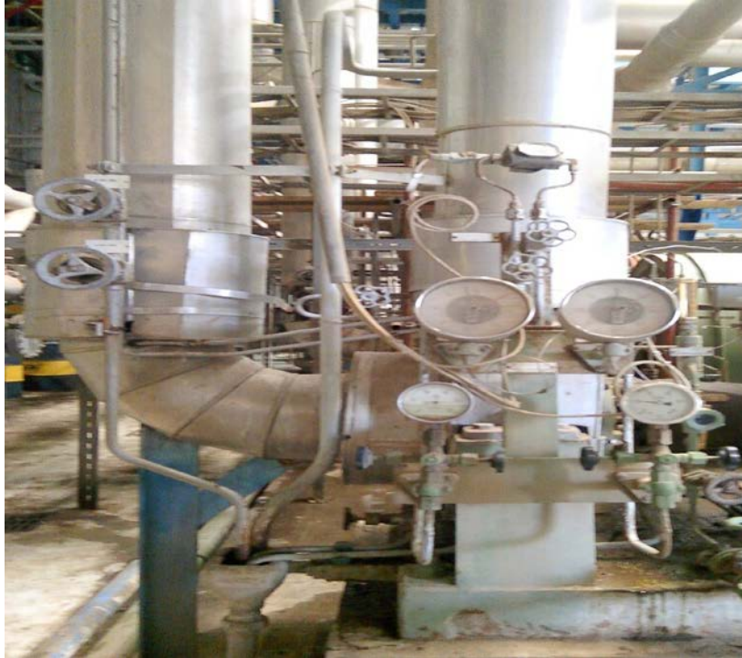
Figure II.8 : Photo de la pompe nourricière
