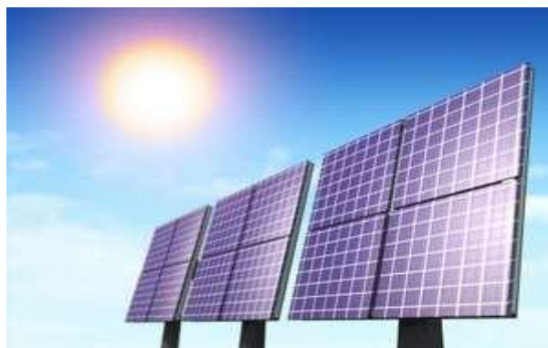
Figure 14 : Panneaux solaires photovoltaïque
