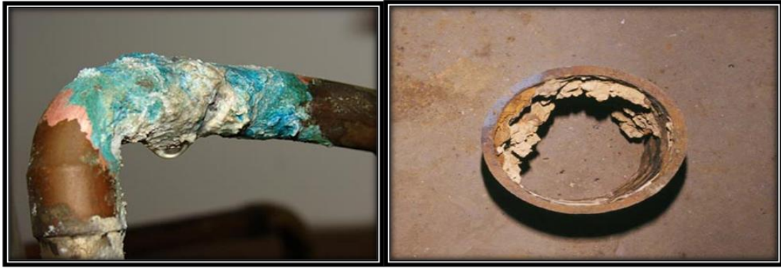
Figure V.10. la corrosion des conduites
