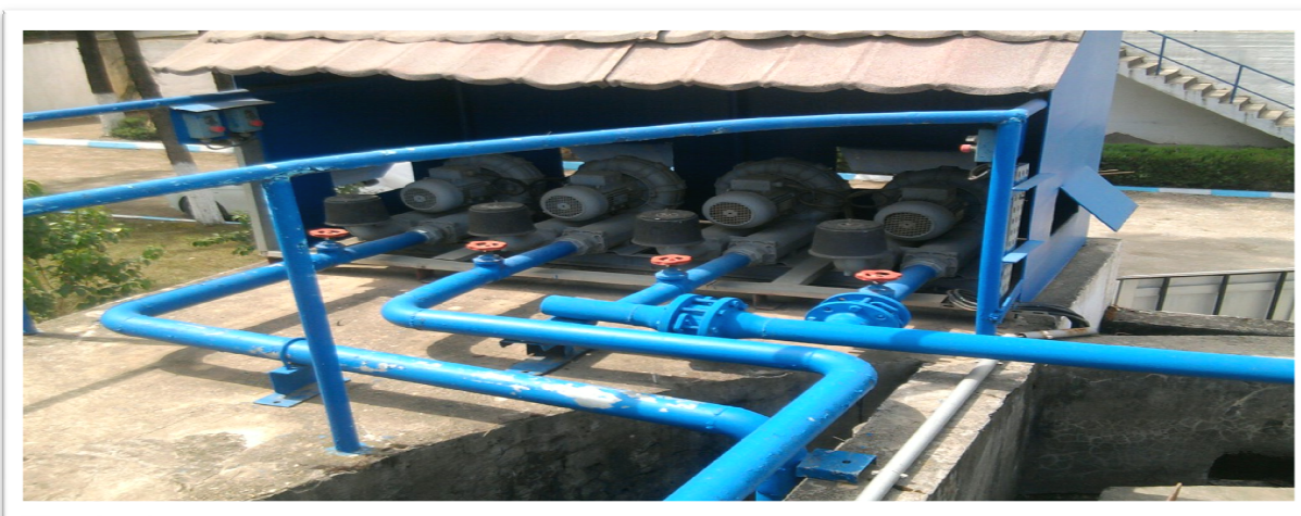
Figure(14) : soufflantes d'air
