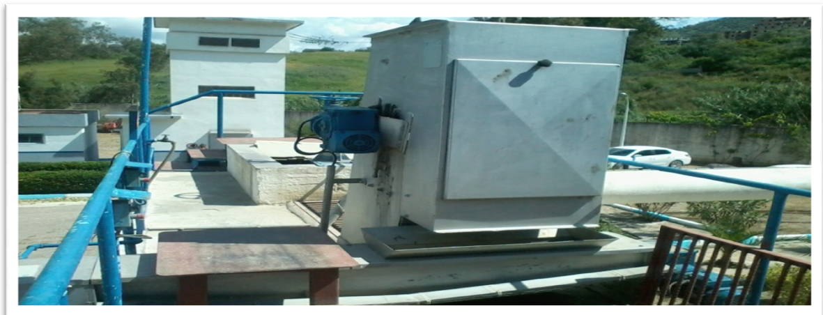
Figure (11) : dégrilleur mécanique
