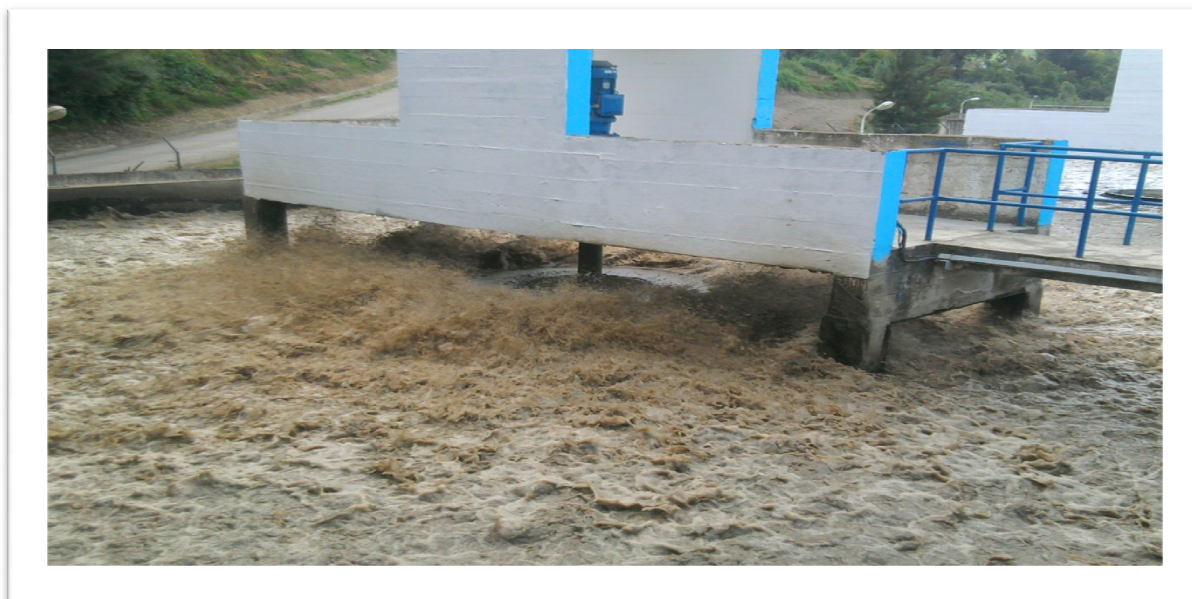
Figure (17) : Aérateur en état de marche.
