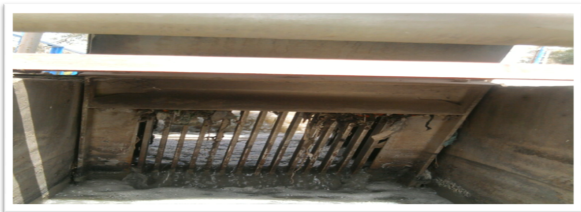
Figure (10) : dégrilleur manuel
