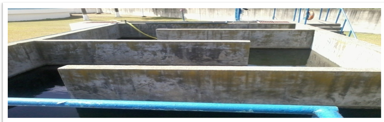
Figure (19) : Bassin de désinfection
