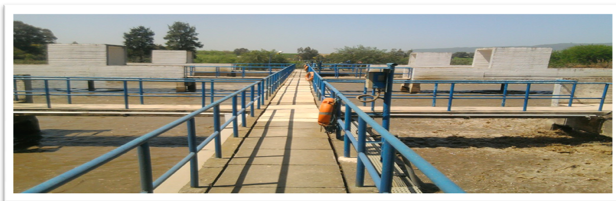
Figure(15) : bassin d'aération
