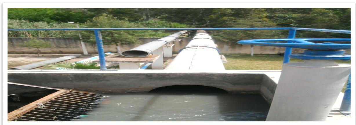
Figure (9) : Arrivée des eaux usées
