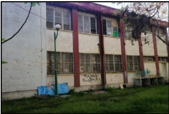
Figure 35 : Dégradation du département d'architecture Source : auteurs
