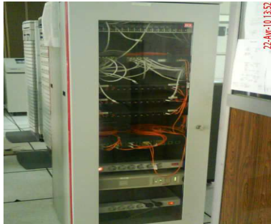
Fig. III.4 L'armoire d'étage centrale
