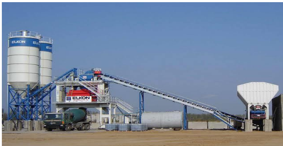
Figure I-03 : Centrale à béton fixe.
