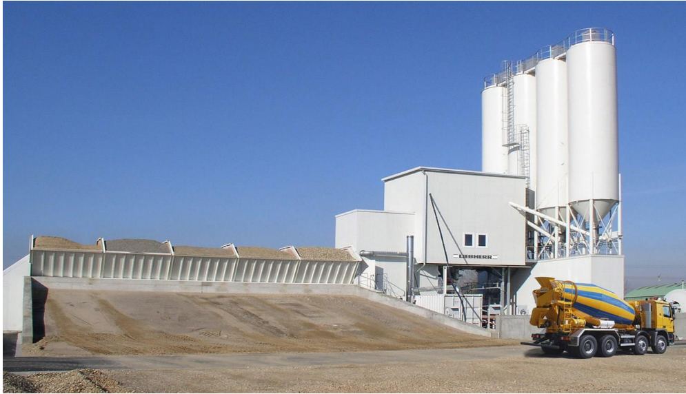
Figure I-02 : Centrale à béton type horizontal.
