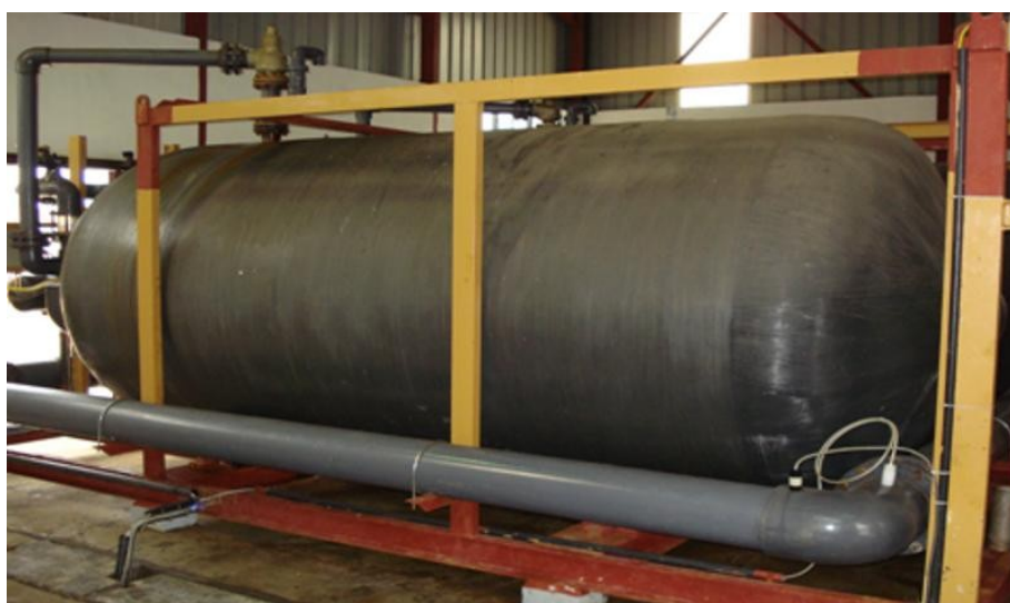
Figure II.3 :Unité de filtres à sable
