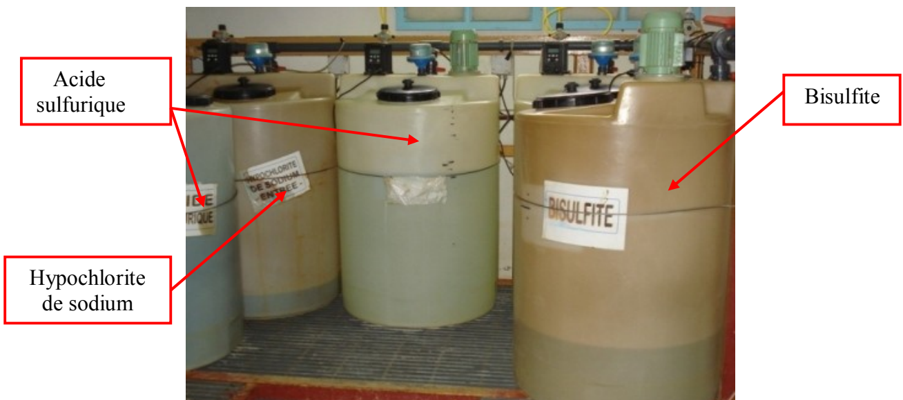
Figure II.2 : Réservoirs d'acides de dosage
