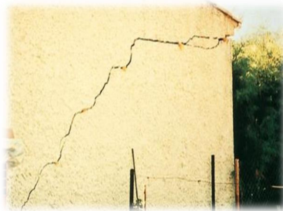
Figure. I.15. Fissures au niveau d'une structure
