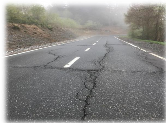
Figure I.20. Déformation d'une chaussée
