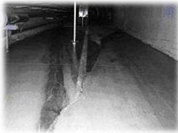
Figure I.21. Soulèvement puis dislocation du radier d'un tunnel
