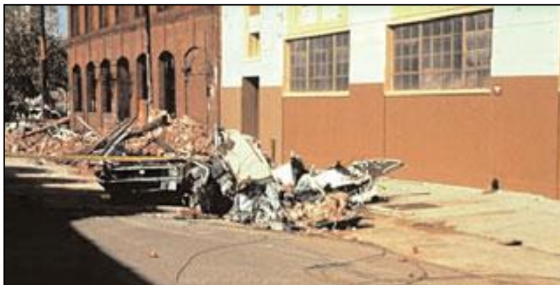
Figure 2.16. La chute de briques de parement lors du séisme de Loma Prieta, Californie, 1989.
