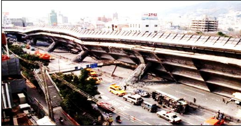
Figure 1.1. Tremblement de terre de Kobe. Janvier 1995.
