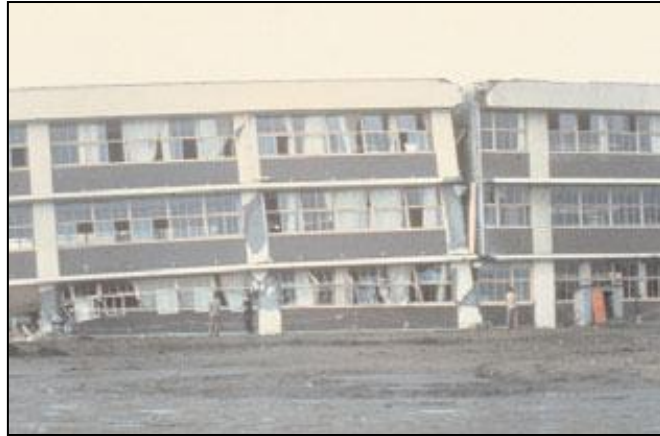
Figure 2.14. Dommages dus à l'entrechoquement de deux blocs des bâtiments séparés par un joint de dilatation thermique (séisme de Tokachi-Oki, Japon, 16 mai 1968)
