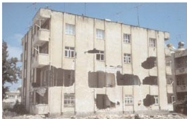
Figure 2.19. Bâtiment endommagé lors de l'effondrement d'une construction voisine (déblayée avant la photo), séisme de Ceyhan-Misis, Turquie, 27 juin 1995
