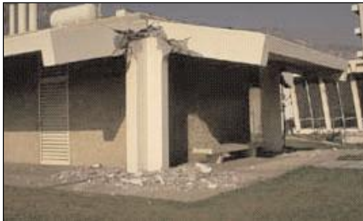
Figure 2.8. Rupture d'un auvent en porte à faux (Séisme de San Fernando, Californie, 1971)
