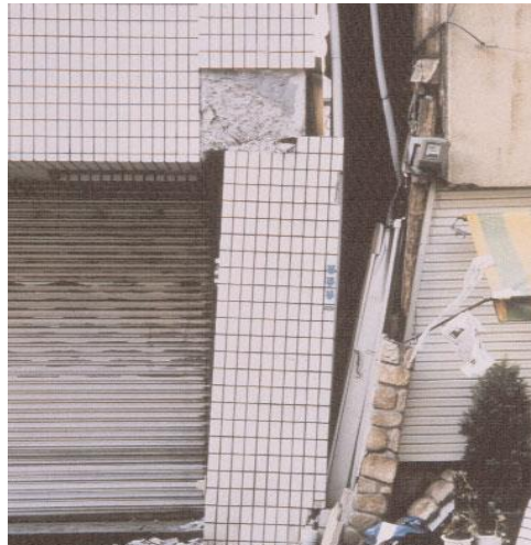
Figure 2.18. Dommages dus à l'entrechoquement de bâtiments voisins (séisme de Kobé, Japon, 17 janvier 1995)
