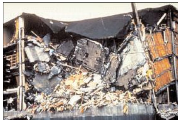
Figure 2.13. Effondrement d'un bâtiment par torsion en raison d'une disposition asymétrique des murs assurant le contreventement (séisme d'Anchorage, Alaska, 27 mars 1964)
