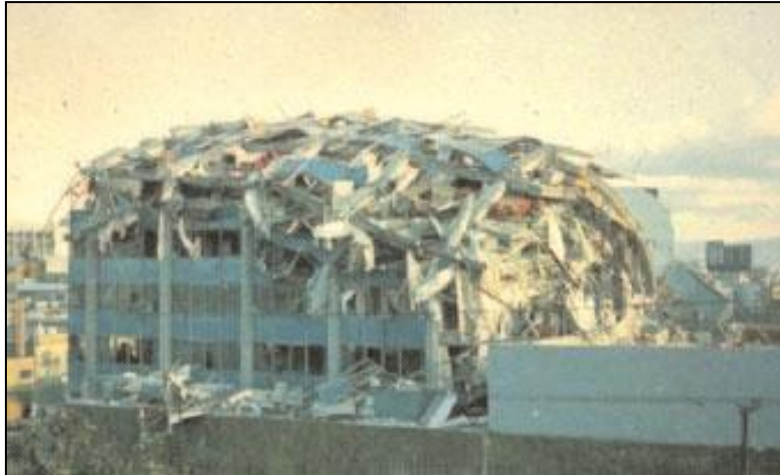
Figure 2.17. Dommages dus à la résonance du bâtiment avec le sol (Mexico, séisme du Mexique, 19 septembre 1985)
