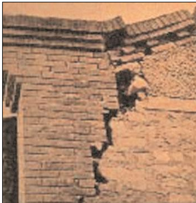
Figure 2.15. Rupture d'un mur hétérogène (séisme de Tangshan, Chine, 28 juillet 1976)
