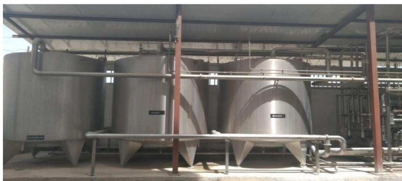
Figure n°20 : la station de C.I.P : l'acide, la soude, et l'eau de rinçage (STLD2021).
