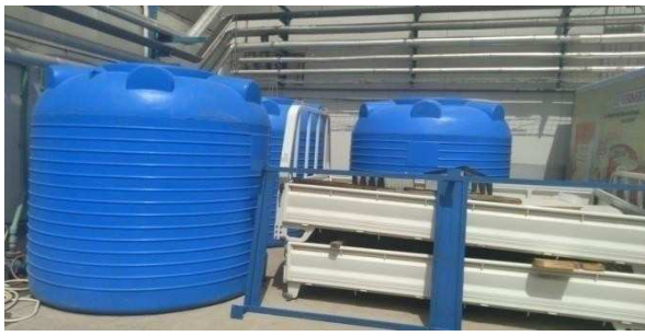
Figure n°24 : Cuve de stockage d'eau (STLD 2021).
