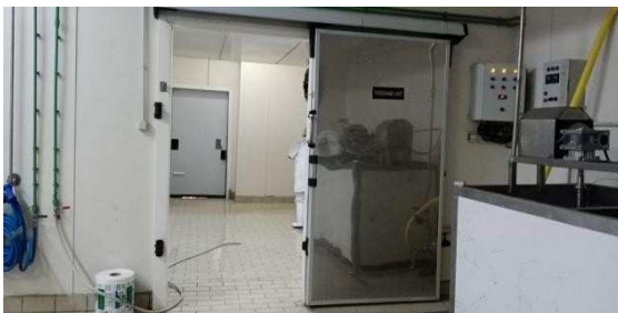
Figure n°16 : chambre froide (STLD2021) .
