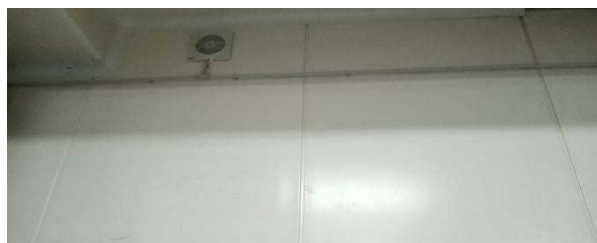
Figure n°22 : les ventilateurs (STLD 2021).
