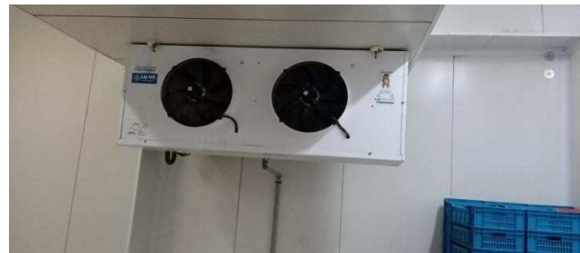
Figure n°17 : ventilateur à l'intérieure de la chambre (STLD 2021)
