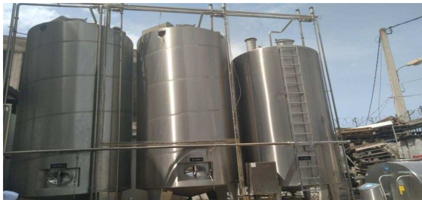
Figure n°11 : les cuves de stockage de lait réceptionné (STLD 2021).
