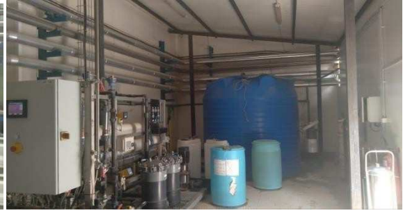
Figure n°25: traitement d'eau (osmoseur) (STLD 2021).
