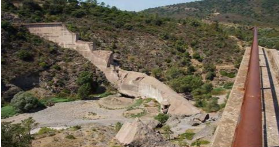
Figure I.5: Barrage de Malpasset après la rupture
