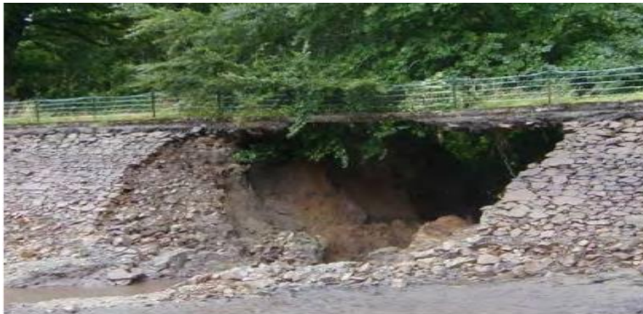
Figure I.6: Barrage des Ouches après la rupture
