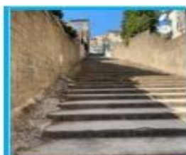
Figure 137 Escalier non structurer, en état de dégradation
