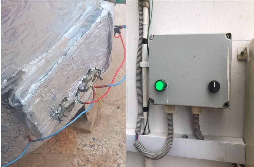
Figure.V.6 : la résistance électrique avec son armoire.
