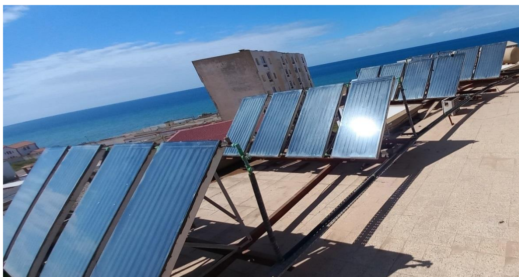
Figure.V.3: les capteurs solaires posés sur la terrasse de l'UDES.
