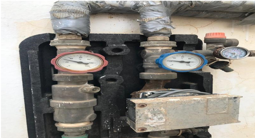
Figure.V.9 : Thermomètre et manomètres mesurant la température et la pression.
