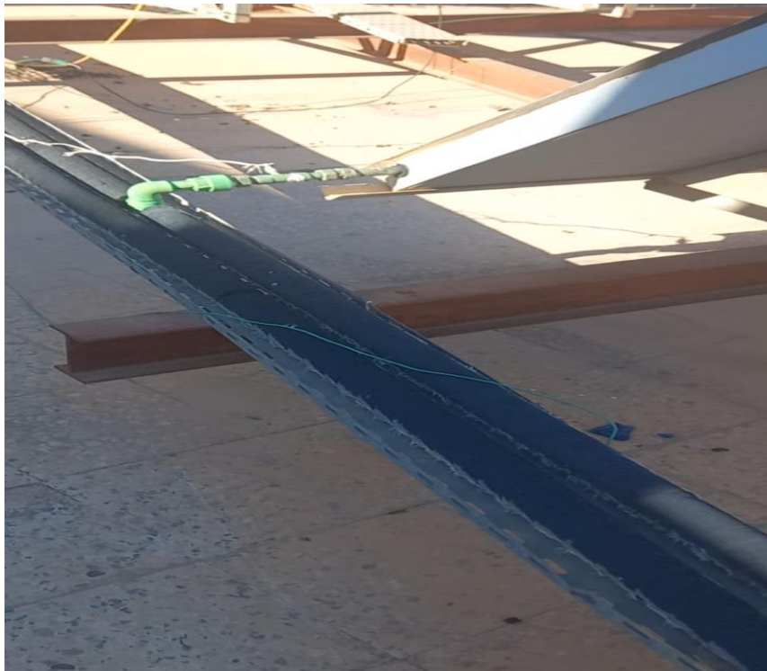
Figure.V.5 : les conduites isolées avec l'armaflex.
