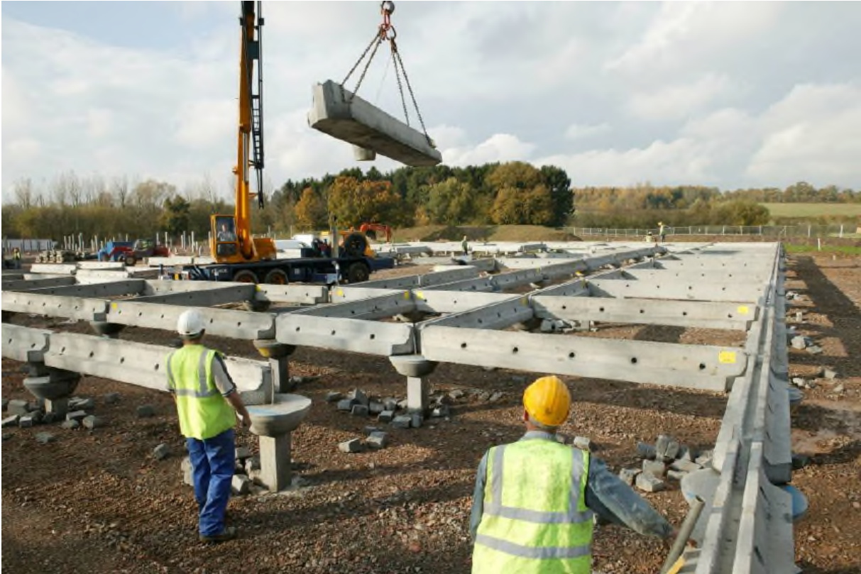
Figure 4-13: Longrines en béton préfabriquées sur pieux pour supporter une ossature constituée d'éléments minces en acier.
