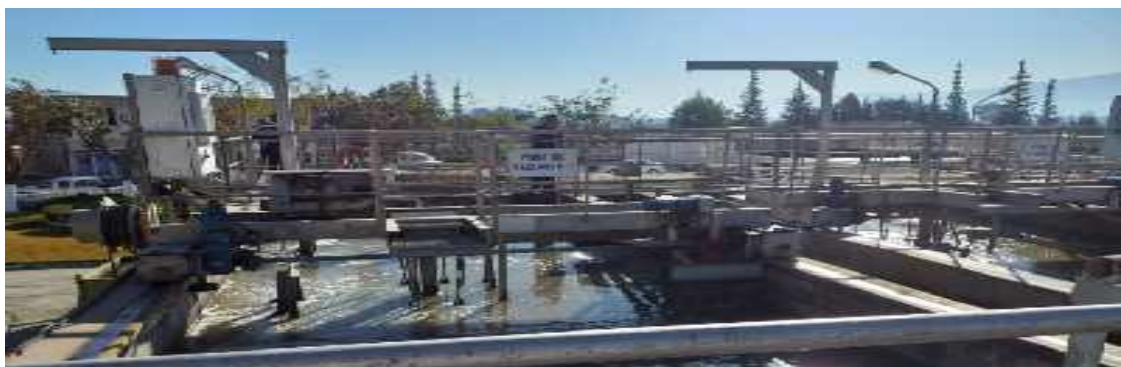
Figure 8 : Ponts de raclage
