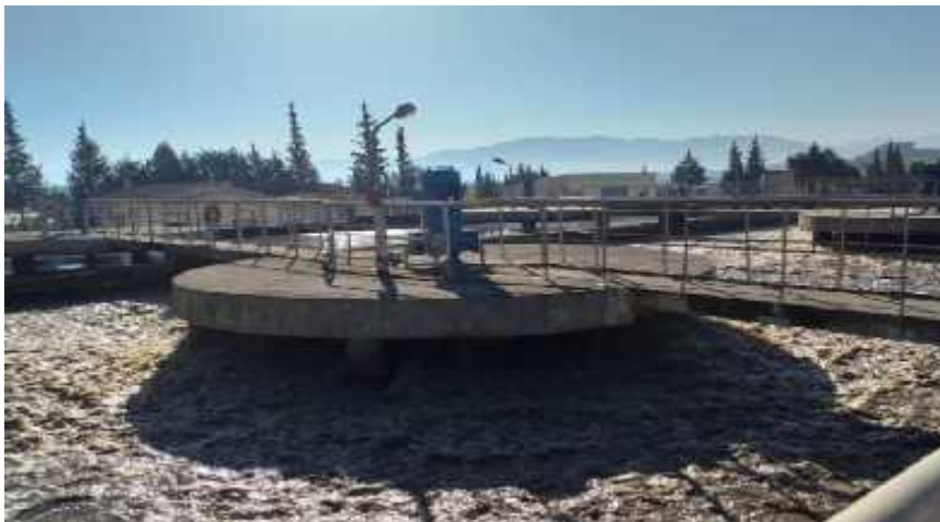
Figure 10 : Le bassin d'aération
