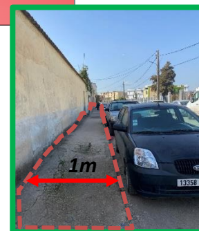
Figure 59: Photo représente l'état de la chaussée Source : prise par l'auteur Date 04/11/24
