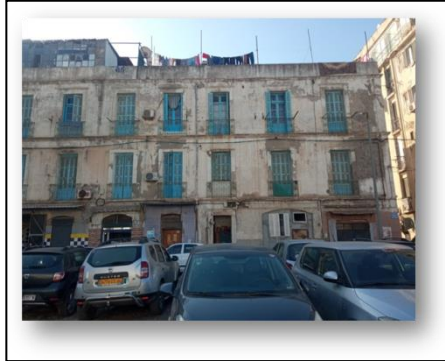
Figure 23 : Façade en moyen état Source : photo prise par auteurs
