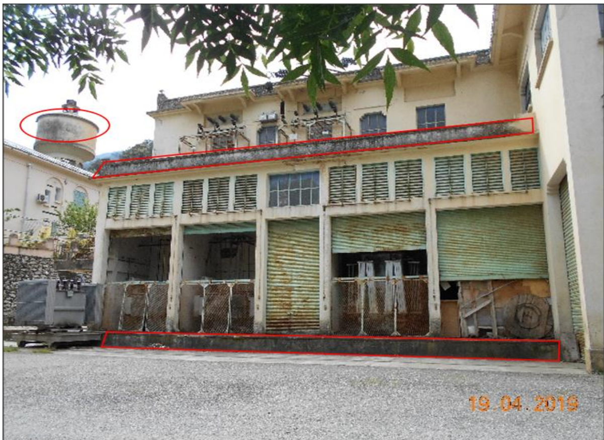
Figure 70: Dégradation des enduits extérieurs Source : Auteur
