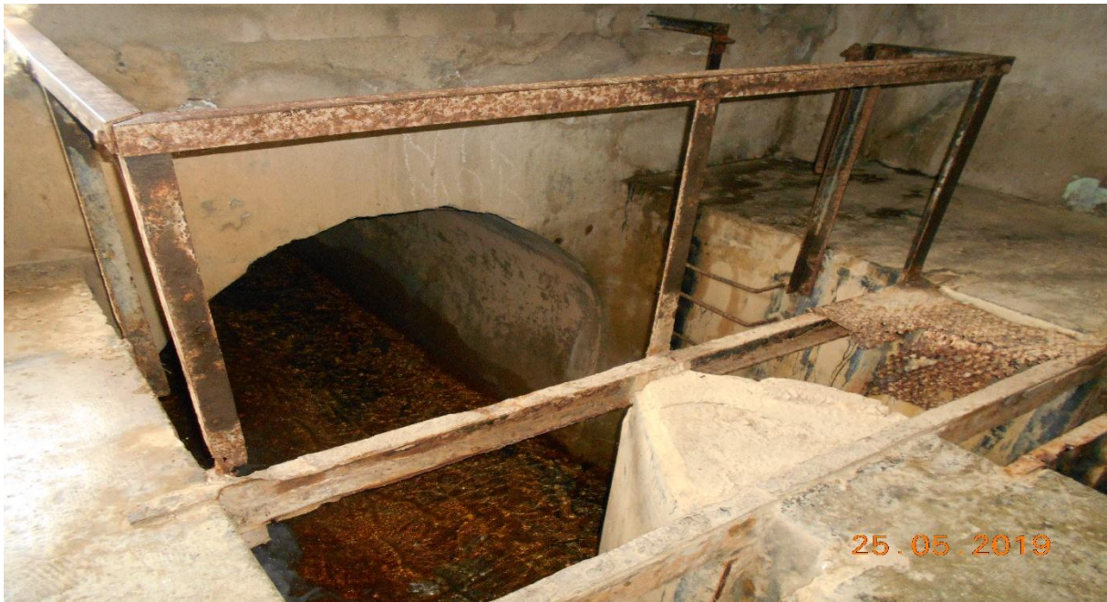
Figure 30: Centrale hydro-électrique de Boghni : Vue sur le début des galeries sous terraines
