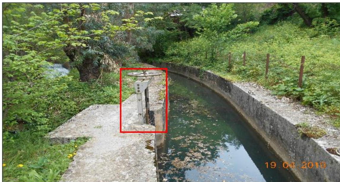
Figure 63 : Trace d'érosion sur les vannes d'évacuation d'eau Source : Auteur
