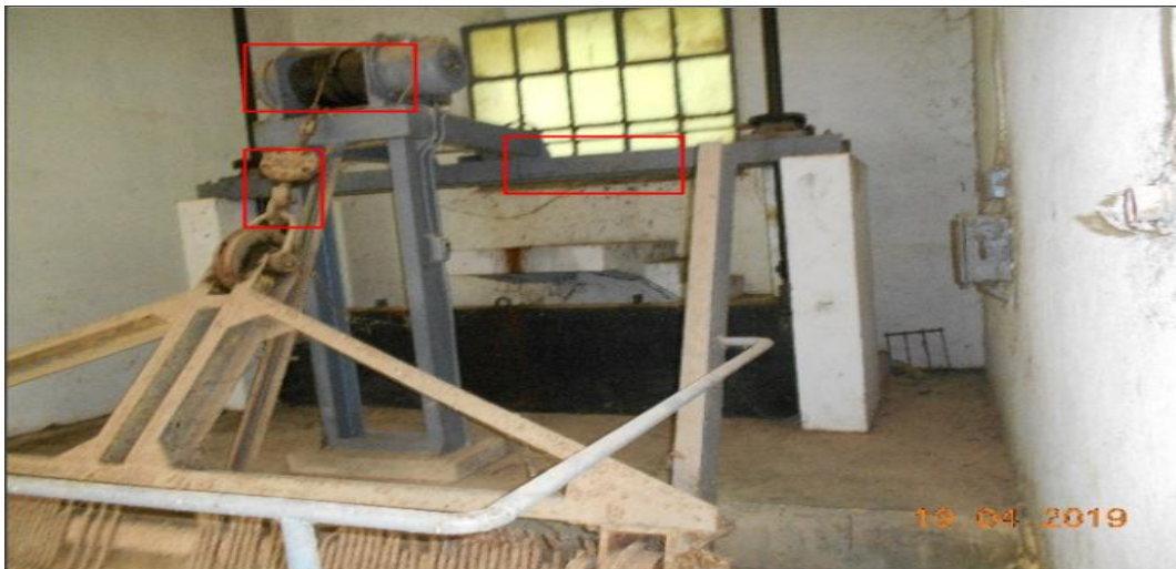
Figure 61 : Quelques traces d'érosions dans une annexe de la partie distribution Source : Auteur
