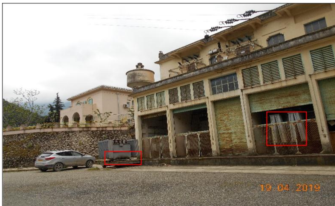
Figure 64 : Traces d'érosion dans la partie distribution Source : Auteur
