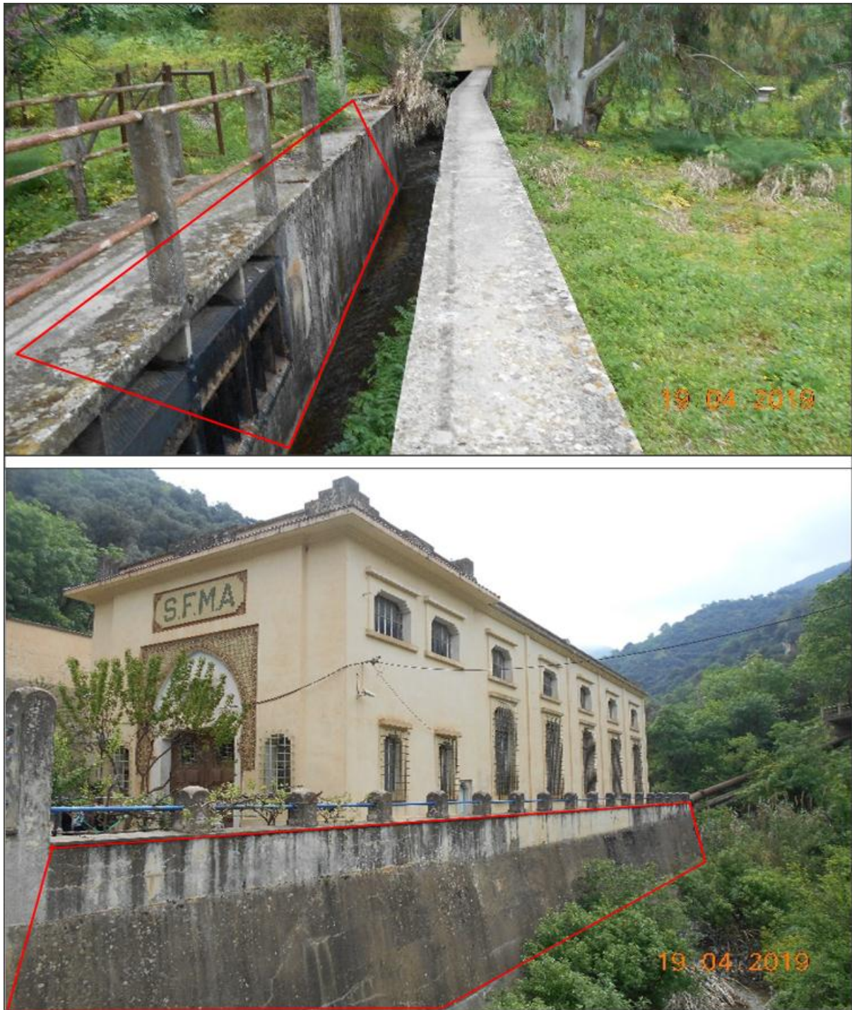
Figure 72: Deux photos illustrant les dégradations des enduits dans les aménagements extérieurs. Source : Auteur
