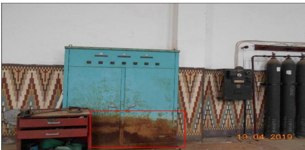
Figure 62 : Erosion visible sur une armoire de la salle des commandes Source : Auteur
