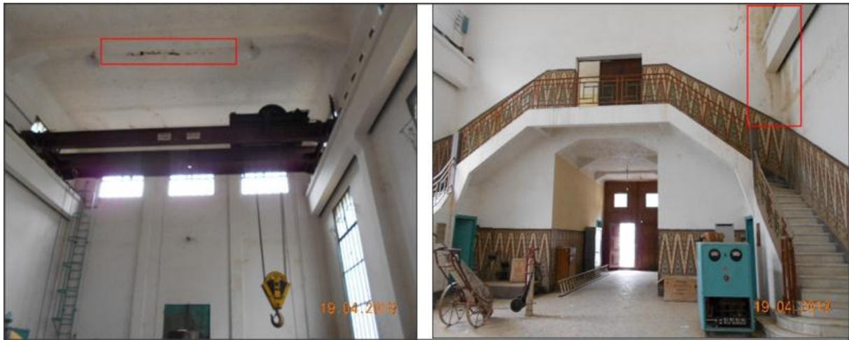
Figure 69 : Traces d'infiltrations d'eau dans l'usine Source : Auteur
