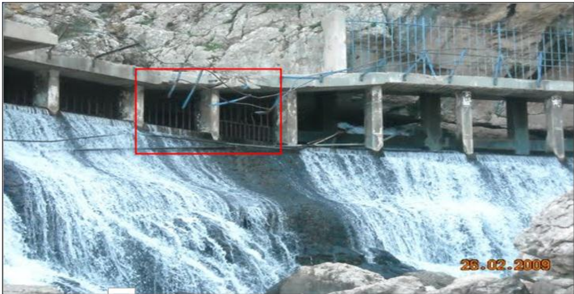
Figure 27 : Centrale Hydro-électrique de Boghni : Vue sur la Bâche et ses déversoirs -
