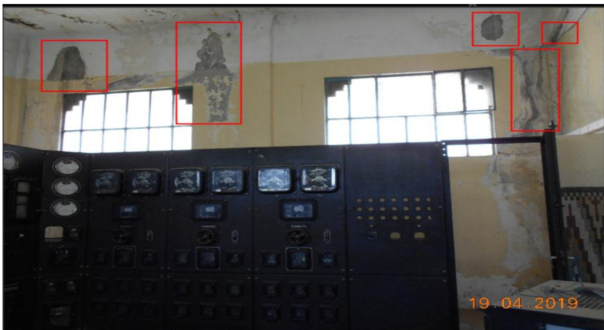
Figure 68: Traces d'infiltrations dans la salle des commandes Source : Auteur
