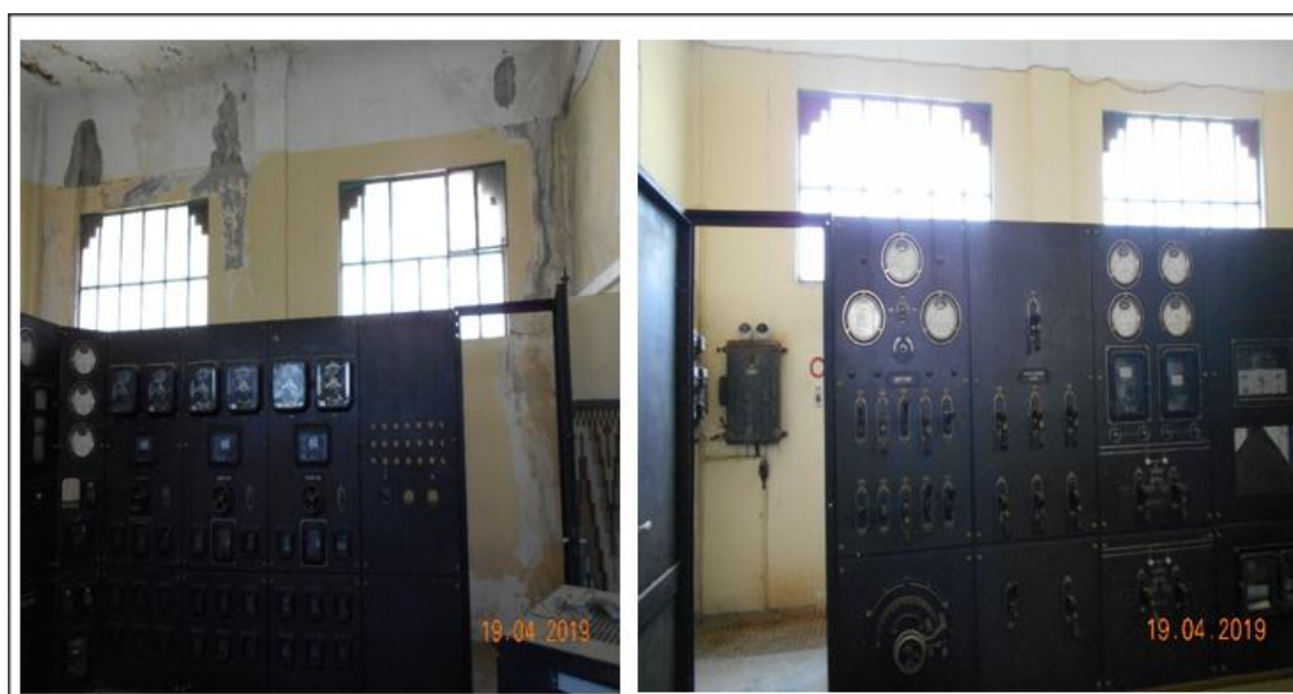
Figure 45 : Vue sur la salle de commandes de l'usine. Source : Auteur
