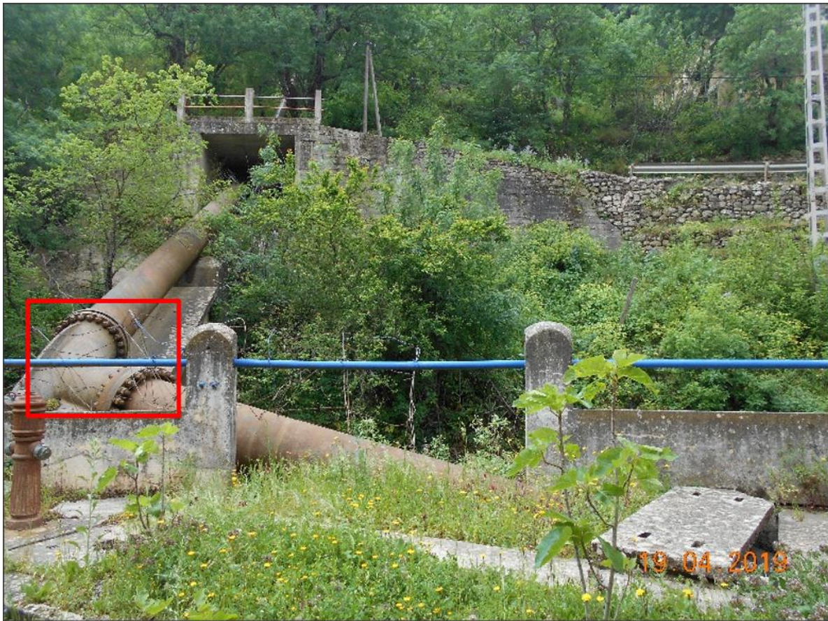
Figure 34 : Centrale Hydro-électrique de Boghni : Vue sur la conduite forcée -Source Auteur – 2019
