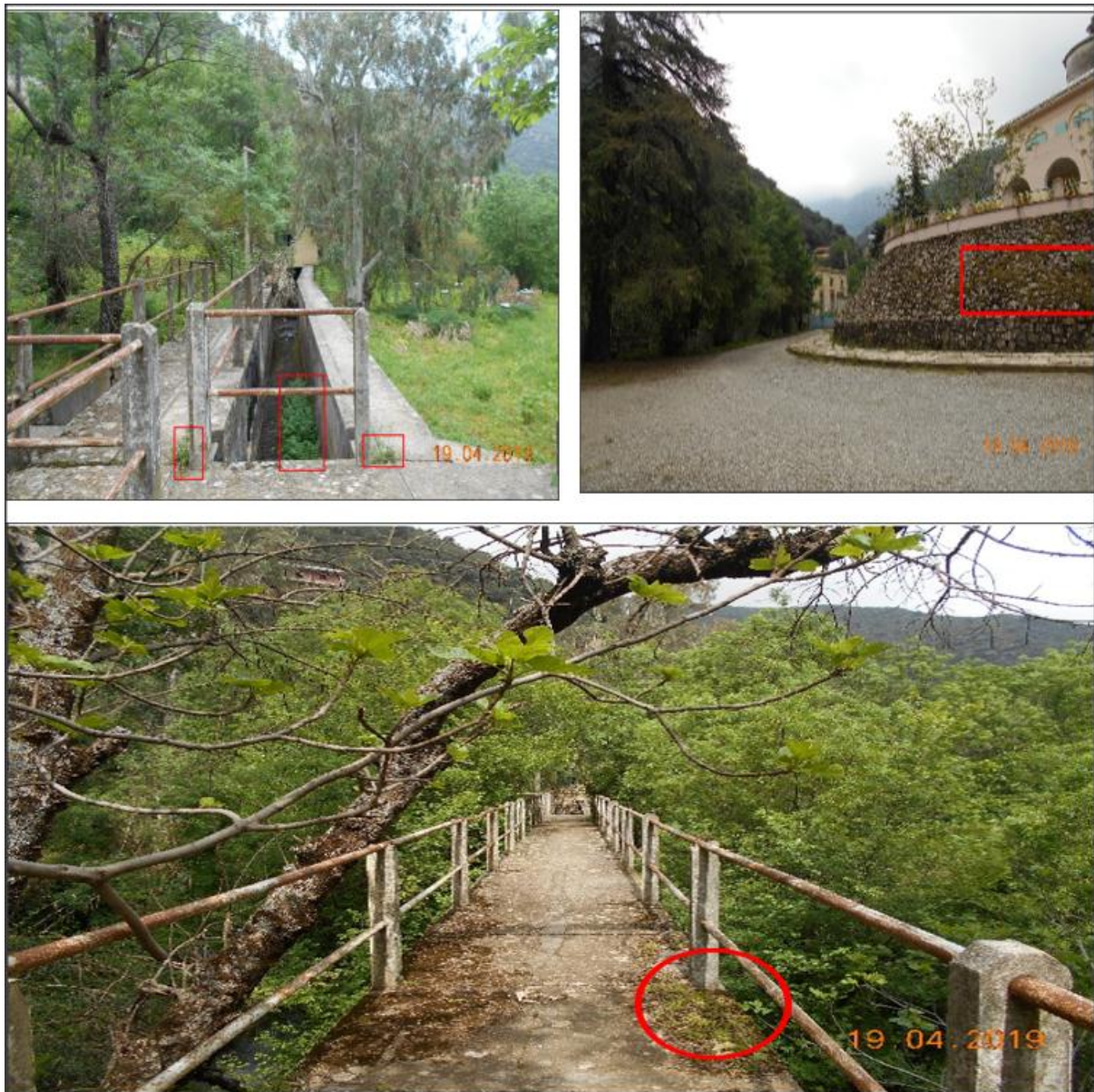
Figure 73: Prolifération de la végétation dans les aménagements extérieurs Source : Auteur
