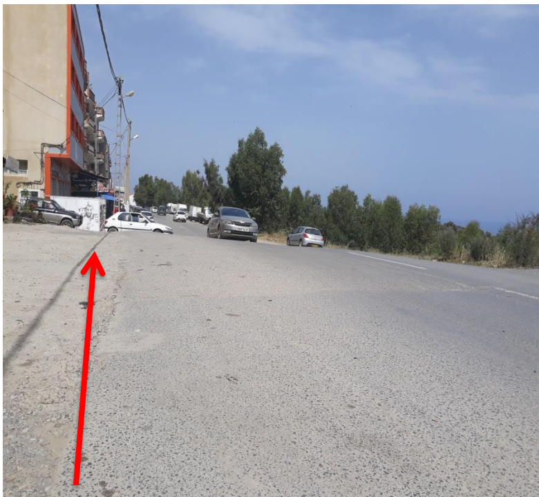
Figure 46 : photo montrant un soulèvement de la route dans le centre de la ville de Tizirt.
