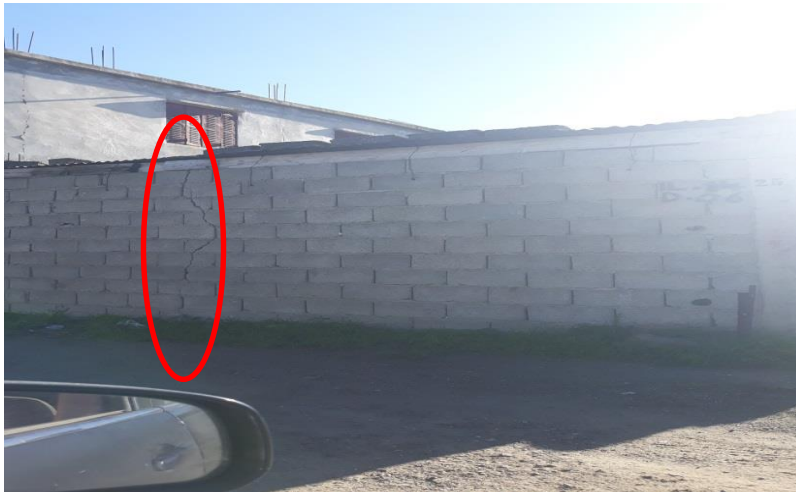
Figure 65 : photo montrant la fissuration d'un mur d'une maison à Azazga.
