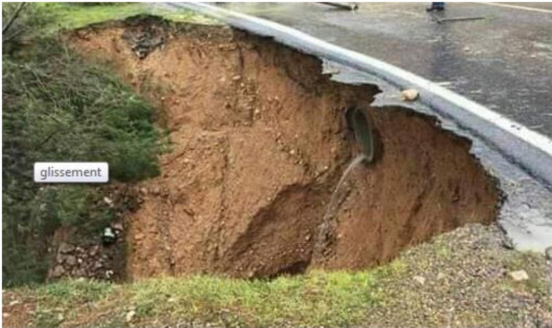
Figure 37: glissement de terrain sur la route nationale N°9.
