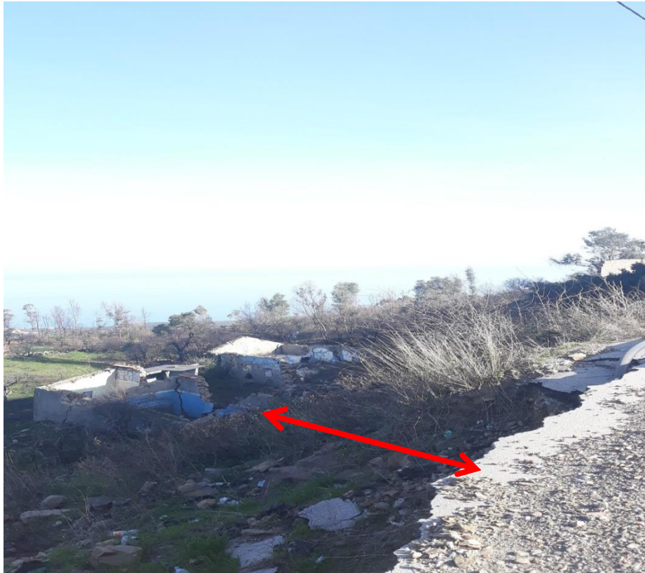
Figure 29 : déplacement d'une maison entière suite à un effondrement du sol au village Iknache.
