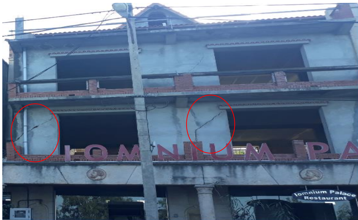
Figure 47 : photo montrant des fissurations au niveau d'un mur d'une maison au centre de Tizirt.
