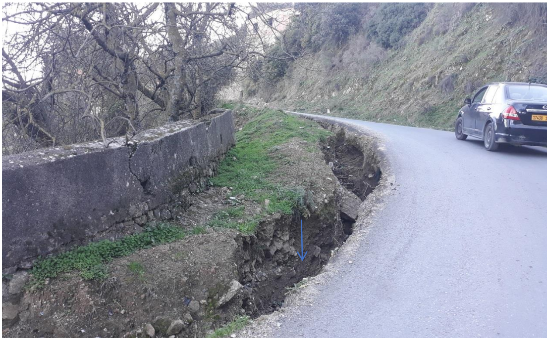
Figure 26 : affaissement de la route vers larbaa nath irathen
