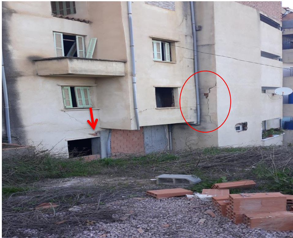
Figure 48 : photo des fissurations d'un mur d'une grande bâtisse et un renforcement des poteaux suite à un glissement de terrain.
