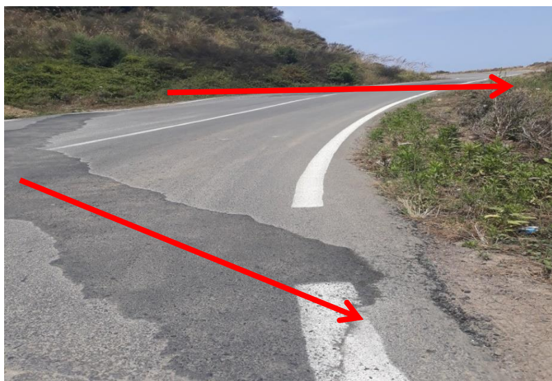
Figure 45 : photo montrant un escarpement de la route indiquant la direction du glissement.
