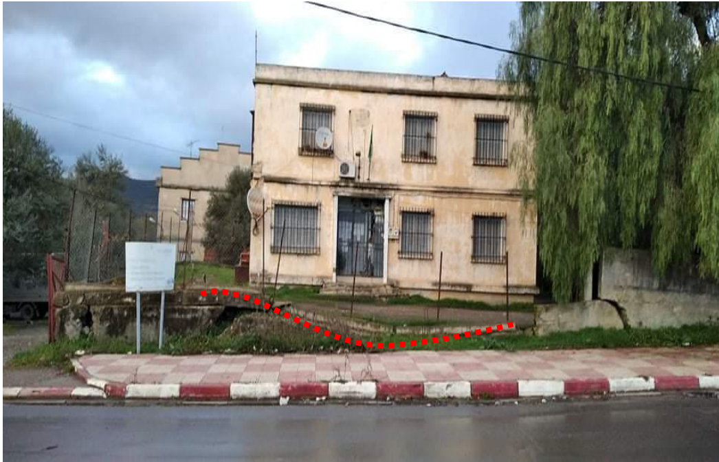
Figure 63 : photo montrant la déstabilisation du siège de l'ADE de la ville d'Azazga (Ighil Bouzel)
