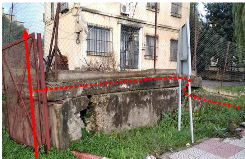
Figure 64 : photo montrant le soulèvement d'une partie du siège de l'ADE d'Azazga (Ighil Bouzel)
