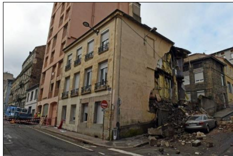
Figure 30: Bati dégradé. Source : Le progrès
