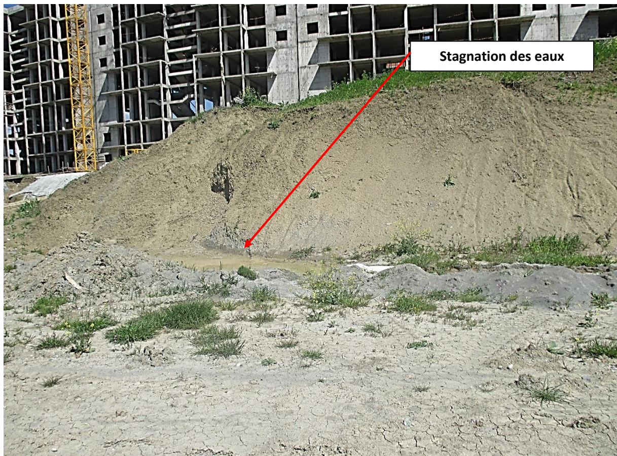
Figure n°3.21: Stagnation des eaux.
