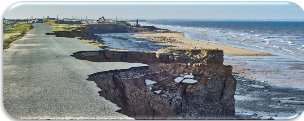
Figure n°1.8 : Érosion côtière à l'est de la baie d'Alger(ALGERIE).
