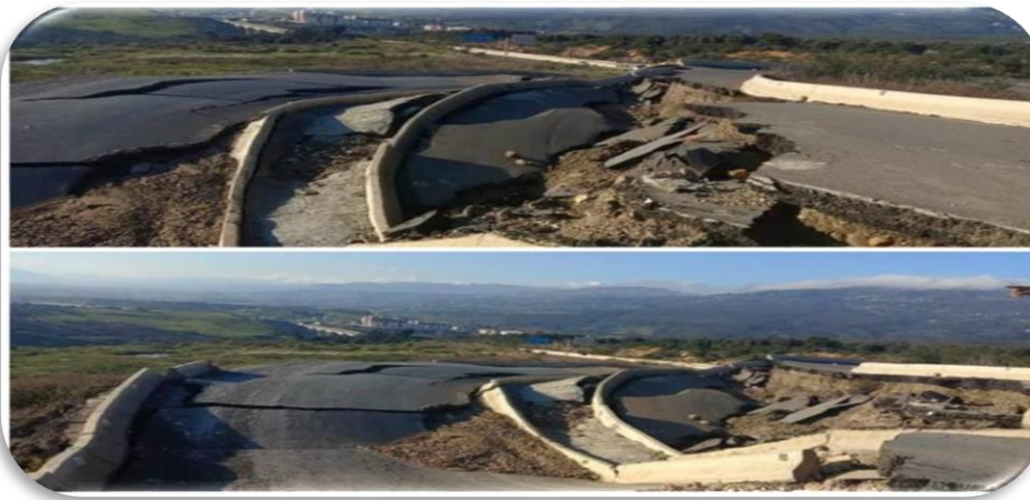
Figure n°1.10 : Affaissement d'un tronçon de route à Azazga Mercredi 16 janvier 2019 (ALGERIE).
