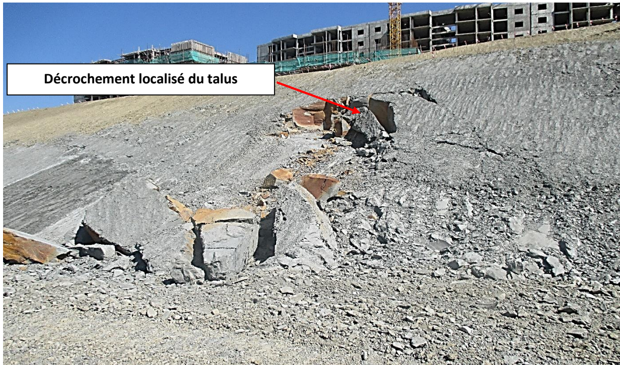
Figure n°3.20: Décrochement du premier talus (présence des traces d'oxydations).
