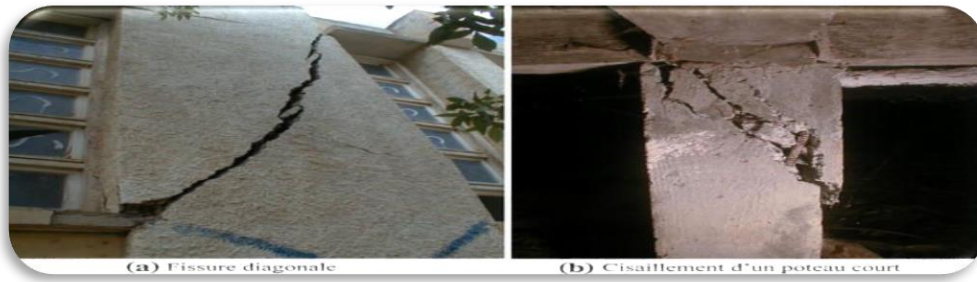
Figure n°1.12 : Pathologie des maçonneries due aux variations volumiques du sol de fondation. M'SILA (ALGERIE).
