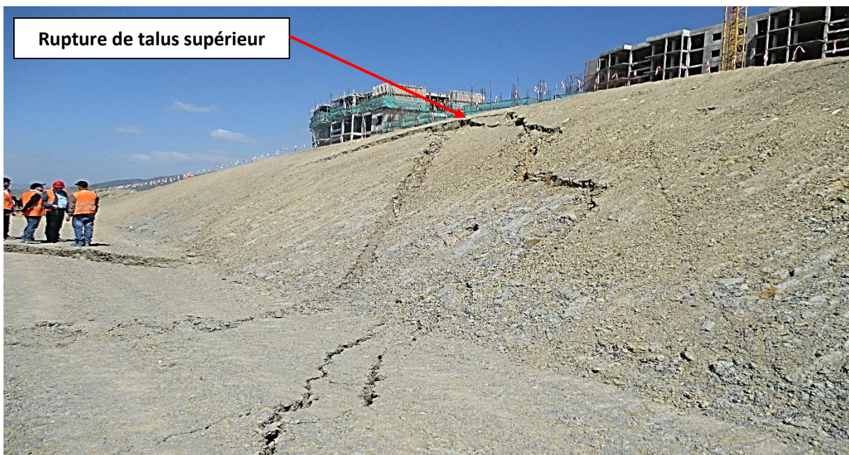
Figure n°3.19 : Décrochement du deuxième talus.
