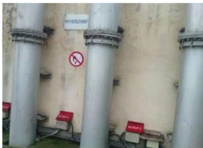
Figure 9 : Poste de relevage (Mouas et Mazouni, 2024).
