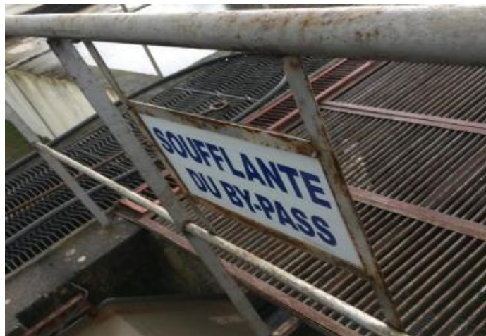
Figure 12 : Soufflants de by-pass (Mouas et Mazouni, 2024).
