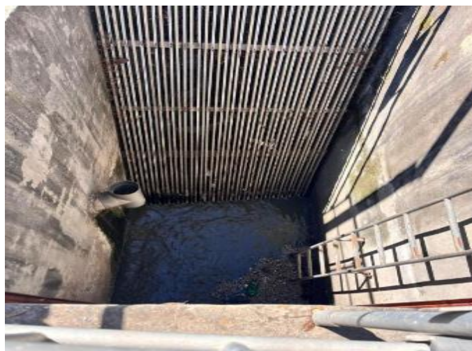
Figure 8 : Dégrillage grossier (Mouas et Mazouni, 2024).
