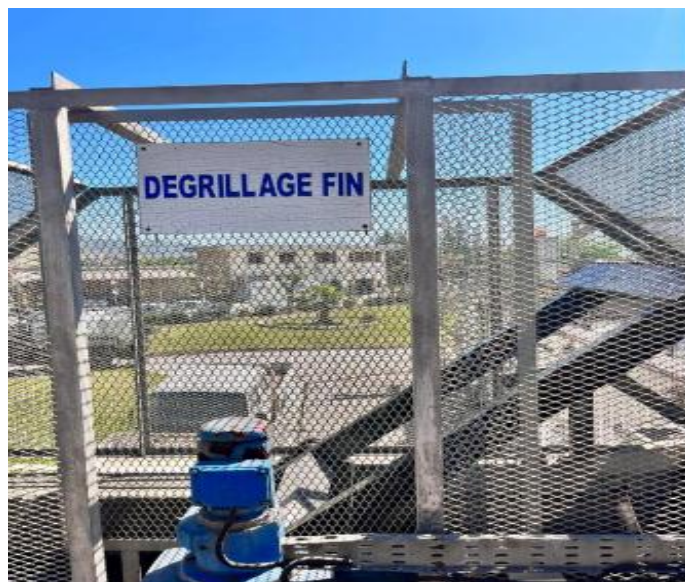
Figure 10 : Dégrillage fin (Mouas et Mazouni, 2024).
