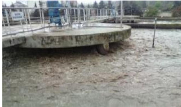
Figure 13 : Bassin biologique (Mouas et Mazouni, 2024).
