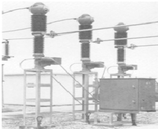
Figure V- 7 : disjoncteur à faible volume d'huile.
