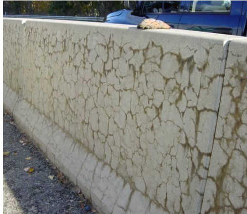
Figure III.8 : Effets de l'Alcali-Réaction sur la bordure de route [35]
