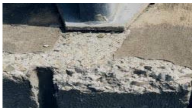
Figure III.3 : Abrasion du béton [29].
