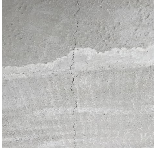
Figure III.2 : Dalle en béton fissurée par retrait [29].
