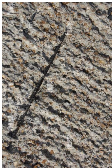
Figure III.4 : Érosion du béton [29]
