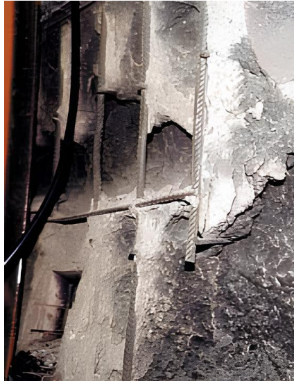
Figure III.6 : Élément structural après exposition au feu [31]
