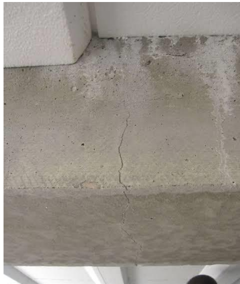
Figure III.1 : Poutre en béton fissuré [29].
