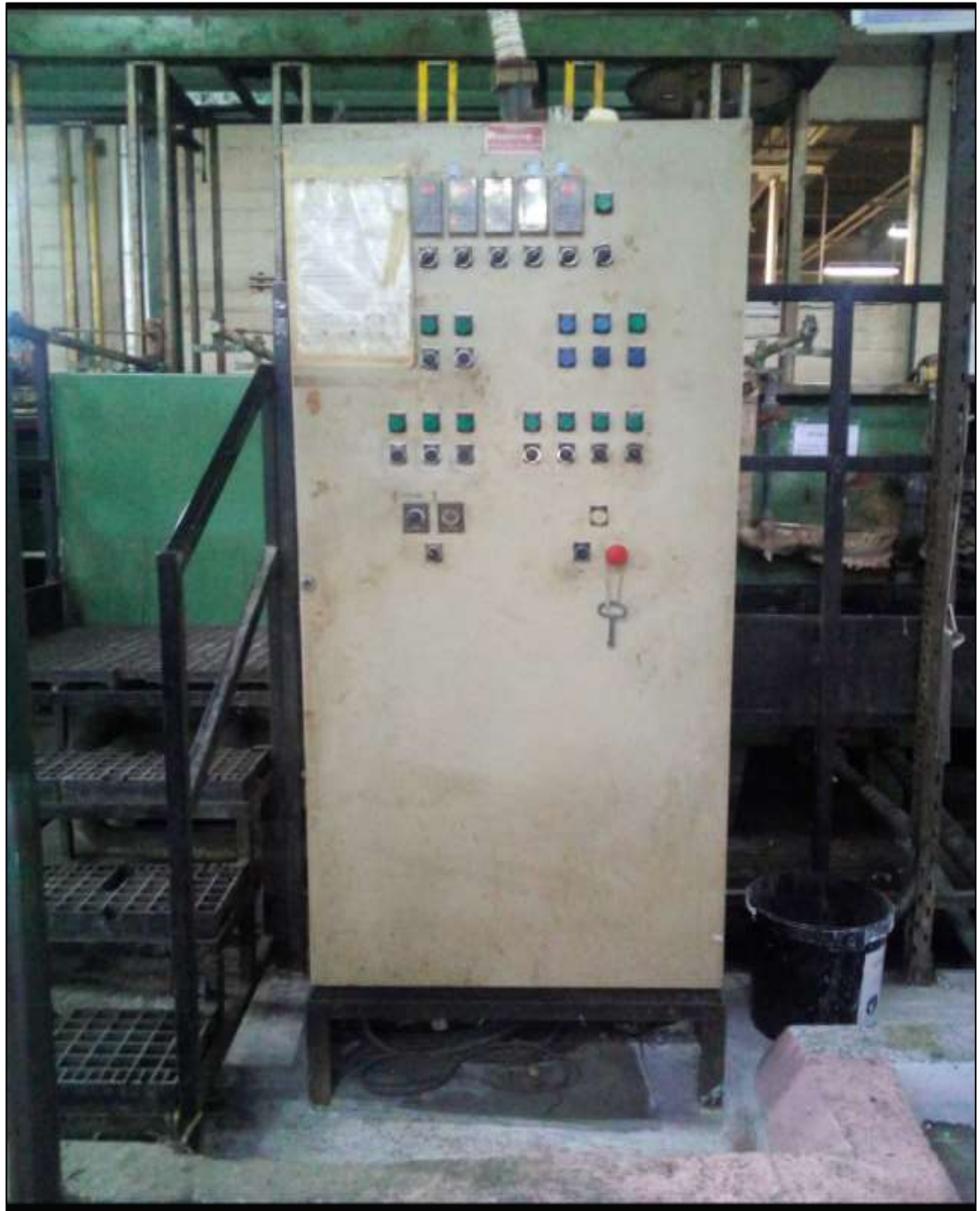
Figure. I.1 Armoire de commande.
