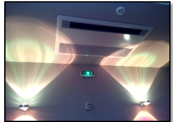
Figure 156 : climatisation dans une chambre d'hôtel.
