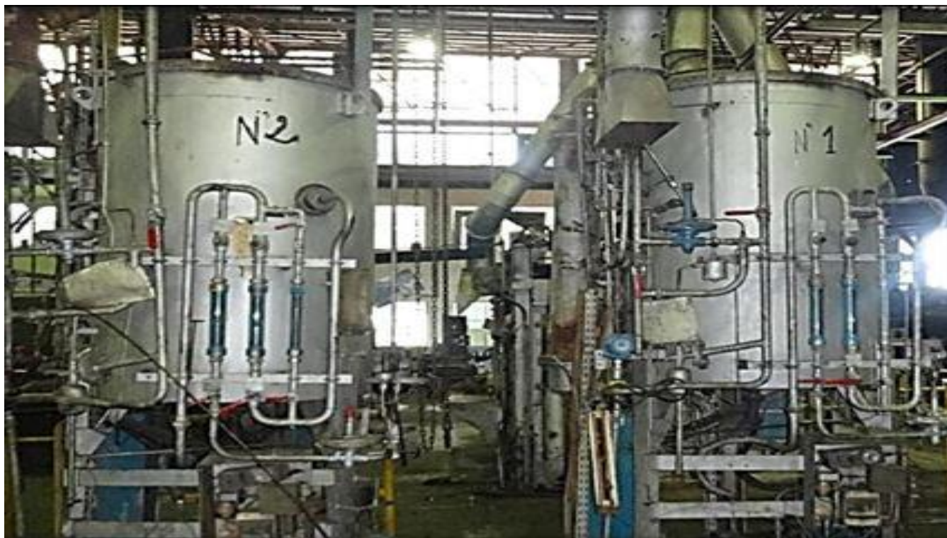
Figure II.3 : Générateurs de gaz endothermique UGINE R20.
