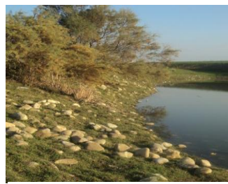
Photo 4.45: Végétation arbustive sur le talus amant et glissement des enrochements
