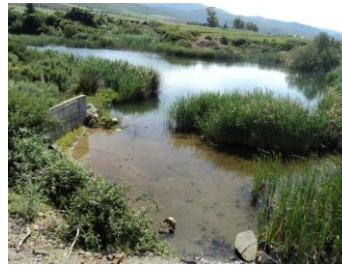
Photo 4.145 : obturation de l'évacuateur de crue
