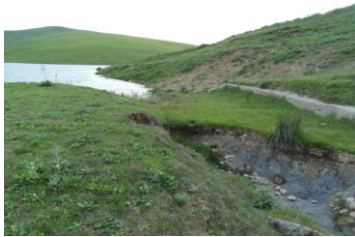
Photo 4.119: Fosse d'érosion à l'intérieur de l'évacuateur
