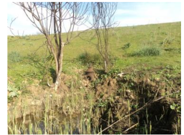
Photo 4.84 : Fuite impotentes dans le talus aval de la retenue
