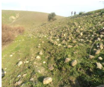
Photo 4.99 : Protection du talus amont vieillie
