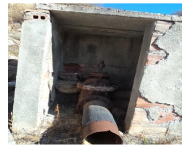
Photo 4.7 : Corrosion et endommagement de la vanne de vidange.
