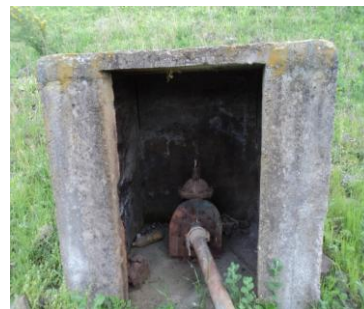
Photo 4.139 : Corrosion de la vanne de vidange et fuite
