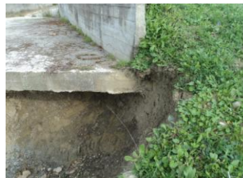
Photo 4.113 : Une grande fosse d'érosion à l'aval
