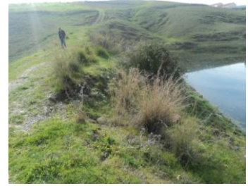
Photo 4.39: Glissement du talus amont.
