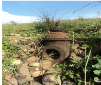
Photo 4.86 : Vanne de vidange endommagée
