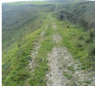
Photo 4.41 : Orniérage sur la crête.
