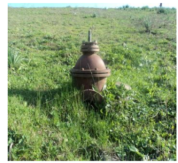
Photo : 4.35 : Corrosion et colmatage de la vanne.
