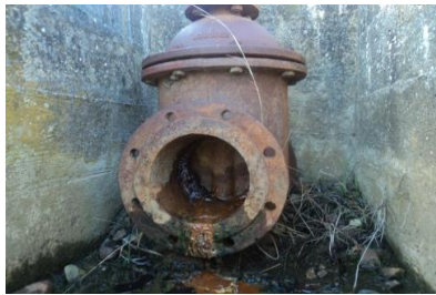
Photo 4.59 : Corrosion et colmatage de la vanne de vidange
