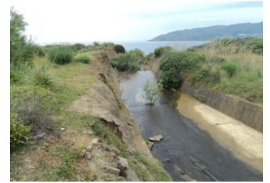
Photo 4.157 : Glissement des murs bajoyers
