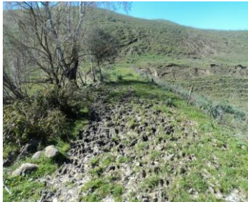
Photo 4.122 : Affaissement de la crête
