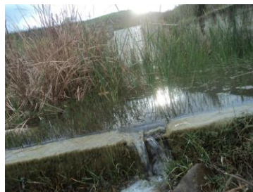
Photo 4.66 : Endommagement du bassin de dissipation d'énergie
