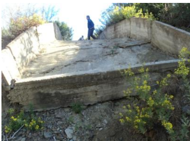
Photo 4.19 : Erosion et effondrement de l'évacuateur de crue.
