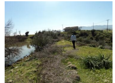
Photo 4.94 : Affaissement de la crête
