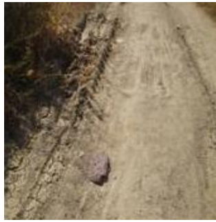
Photo 2.3 : Orniérage sur la crête de la retenue.
