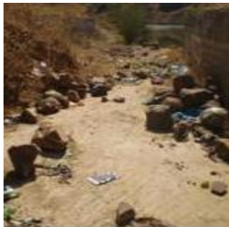
Photo 2.5 : Colmatage de l'évacuateur de crue.
