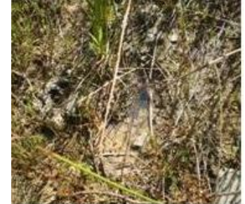
Photo 4.18 : Fuites localisées sur le parement aval.
