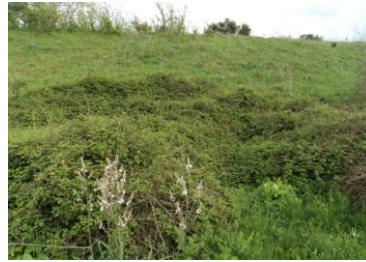
Photo 4.104 : Végétation sur le talus aval
