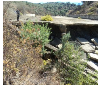
Photo 4.14 : Evacuateur de crue endommagé
