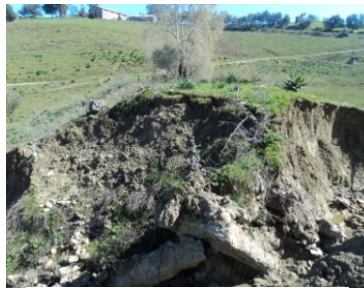
Photo 4.123 : Glissement de la partie rive gauche du corps de la digue
