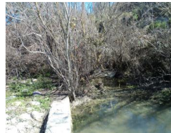
Photo 4.72 : Obturation de l'évacuateur de crue par la végétation.
