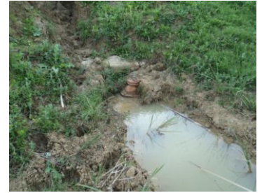
Figure 4.118 : Vanne de vidange endommagée
