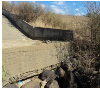
Photo 2.6 : Bassin de dissipation déstabilisé.
