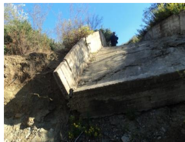
Photo 4.20 : Une grande fosse d'érosion à l'aval du coursier.
