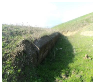
Photo 4.34 : Murs bajoyers présence de fissures
