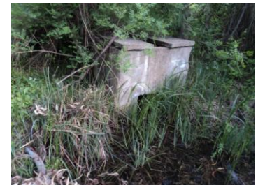
Photo 4.114 : Vanne de vidange émergée dans l'eau
