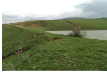
Photo 4.117 : Erosion impotente sur le corps de la digue
