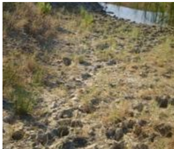
Photo 4.26 : Affaissement de la crête sur la rive.
