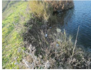
Photo 4.76: Glissement de talus amont de la digue
