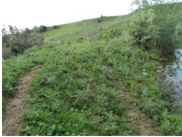
Photo 4.109 : Orniérage sur la crête de la retenue
