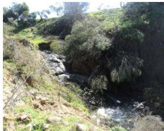
Photo 4.93 : Glissement de terrain et destruction de l'évacuateur de crue
