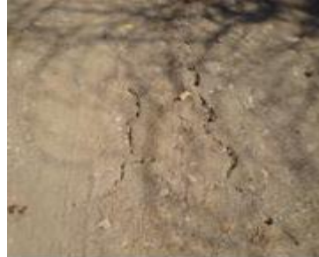
Photo 4.17 : Présence de fissures transversales sur la crête.
