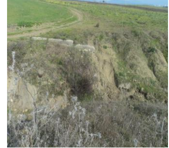
Photo 4.42: Glissement des murs bajoyer.
