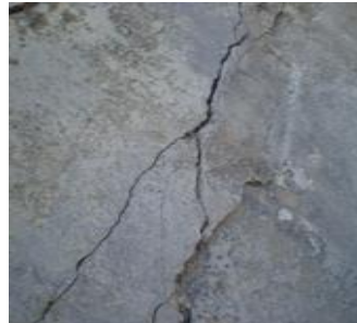
Photo 4.27 : fissures sur le coursier
