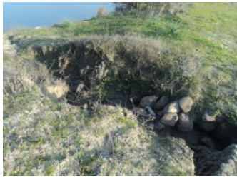
Photo 4.75 : Ravines importantes sur le côté rive gauche de la digue
