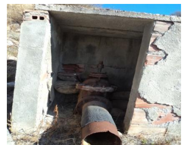
Photo 2.7: Corrosion et endommagement de la vanne de vidange.
