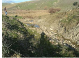
Photo 4.97 : Glissement de la partie gauche du talus aval
