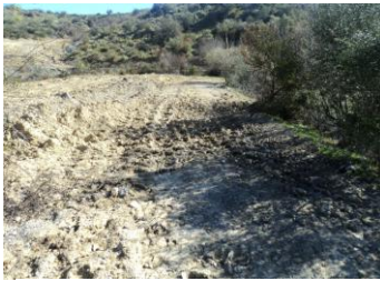
Photo 4.69 : Affaissement de la crête de la retenue.
