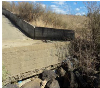
Photo 4.6 : Bassin de dissipation déstabilisé.
