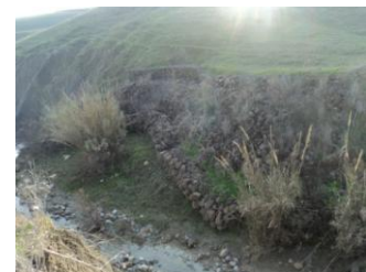
Photo 4.98 : Evacuateur de crue endommagé
