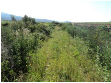
Photo 4.141 : Talus amont et aval envahie par la végétation
