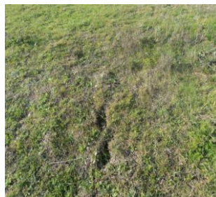
Photo 4.100 : Fissure sur le talus aval de la retenue
