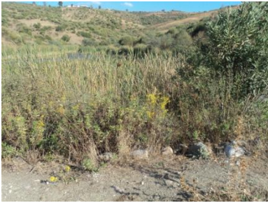
Photo 4.16 : Présence de végétation sur le talus amant.
