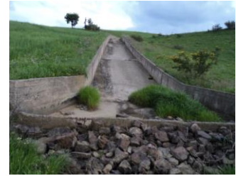
Photo 4.137 : bassin de dissipation fissuré
