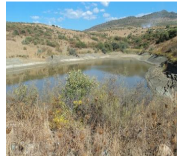
Photo 2.4 : Présence de végétation sur le talus amant.
