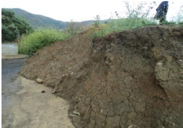
Photo 4.151 : Glissement des terres sur les murs bajoyer
