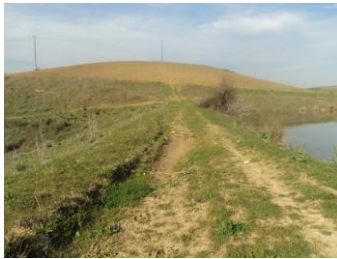
Photo 4.82 : Tassement de la crête de la retenue
