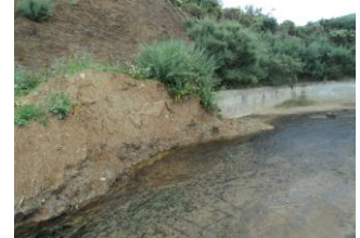
Photo 4.150 : Glissement des terres sur les murs bajoyer
