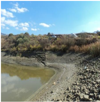
Photo 2.2 : Glissement de terrain sur la berge gauche.
