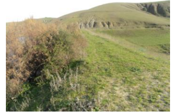
Figure 4.77 : Végétation abusive sur le talus amont
