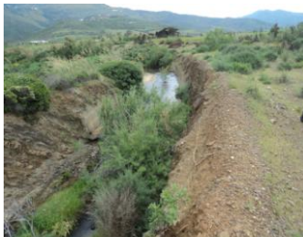
Photo 4.158 : Bassin de dissipation obturé par la végétation
