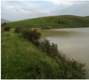
Photo 4.135 : Présence de végétation sur le talus amont
