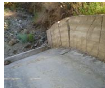
Figure 4.28 : Bassin de dissipation emporté par la crue.
