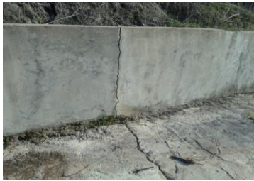
Photo 4.78: Fissure des murs bajoyer
