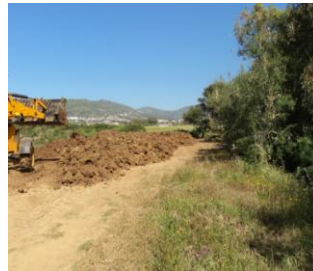
Photo 4.169 : Affaissement de la crête
