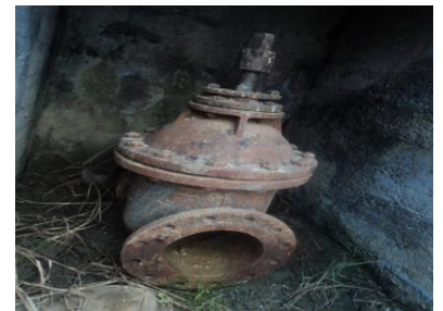
Photo 4.67 : Colmatage de la vanne de vidange.
