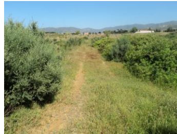
Photo 4.142 : Orniérage sur la crête de la retenue
