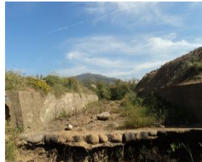
Photo 4.166 : Bassin de dissipation endommagé
