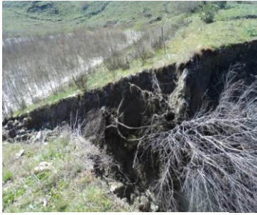
Photo 4.128 : Corps de la digue endommagée
