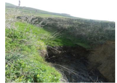
Photo 4.87: Une grande fosse d'érosion à l'aval de l'évacuateur
