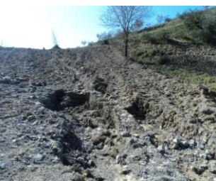
Photo 4.71 : Absence de protection et ravinement du Talus aval.
