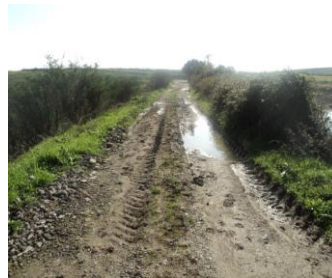
Photo 4.53 : Ornières sur la crête de la retenue.
