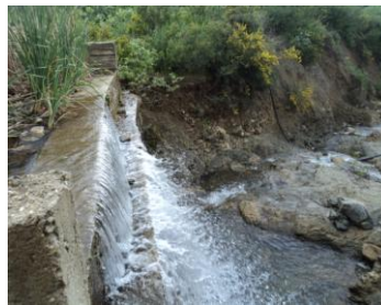
Photo 4.152 : Fosse d'érosion à l'aval de l'évacuateur de crues
