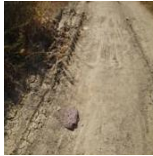
Photo 4.3 : Orniéage sur la crête de la retenue.
