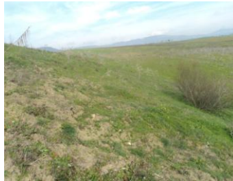
Photo 4.38 : Présence de fissures sur le talus aval.
