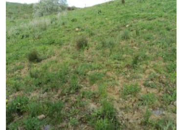
Photo 4.111 : Présence de suintement sur le talus aval
