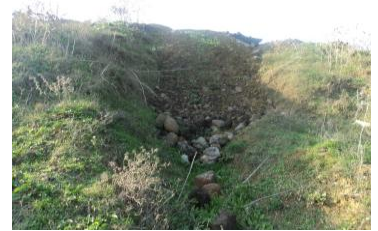
Photo 4.58: Creusement de ravines sur le talus aval.
