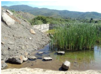
Photo 4.144 : Glissement des terres sur les murs bajoyer
