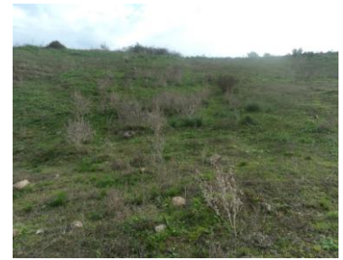
Figure 4.64 : Protection du talus aval vieillie.
