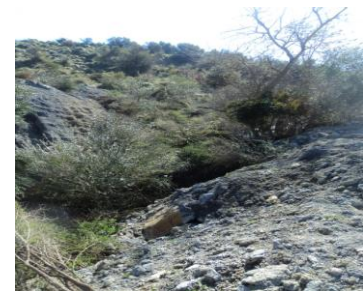
Photo 4.73: Destruction de l'évacuateur de crue.
