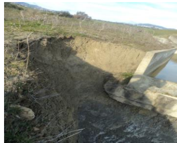
Figure 4.79 : Une grande fosse d'érosion à l'aval l'évacuateur
