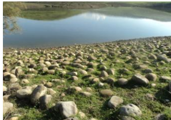
Photo 4.30 : Glissement d'enrochement de talus amant.
