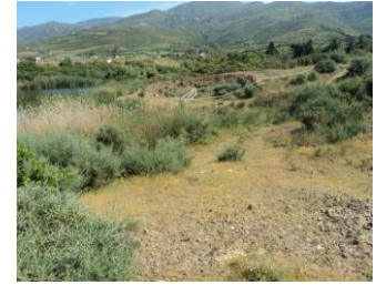
Photo 4.143: Glissement du talus aval de la retenue
