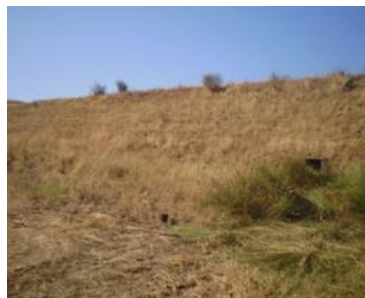
Photo 4.138 : Absence de protection du talus aval
