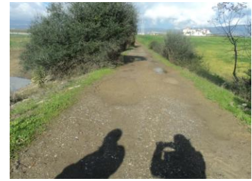
Photo 4.51 : Affaissement de la crête
