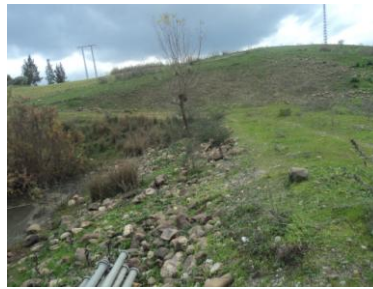
Photo 4.63 : Glissement des enrochements du talus amont.
