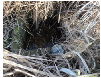
Figure 4.80 : Vanne de vidange émergée dans l'eau
