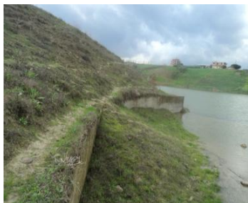
Photo 4.65 : Glissement de terrain sur les bajoyers
