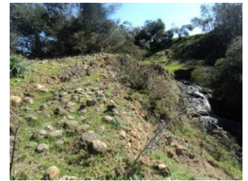
Photo 4.91: Glissement de talus aval de la retenue
