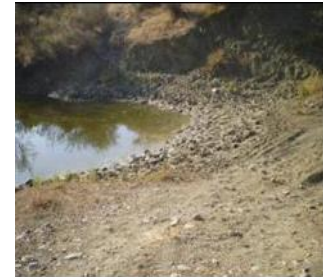
Photo 4.25 : Glissement de la berge.
