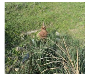
Photo 4.101 : Corrosion de la vanne de vidange
