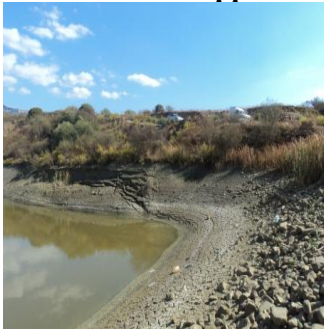
Photo 4.2 : Glissement de terrain sur la berge gauche.
