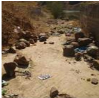
Photo 4.5 : Colmatage de l'évacuateur de crue.
