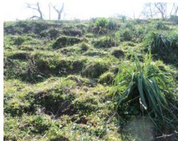
Photo 4.132 : Corps de la digue endommagée
