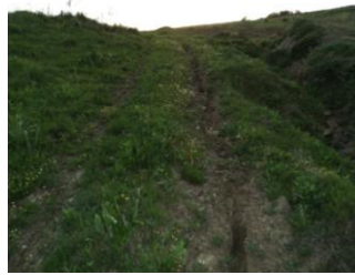
Photo 4.136 : présence des ravines sur le talus aval
