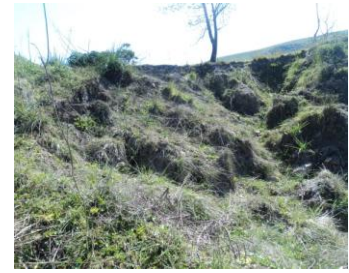
Photo 4.130 : Talus aval de la retenue endommagée
