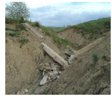
Photo 4.107 : Destruction de l'évacuateur
