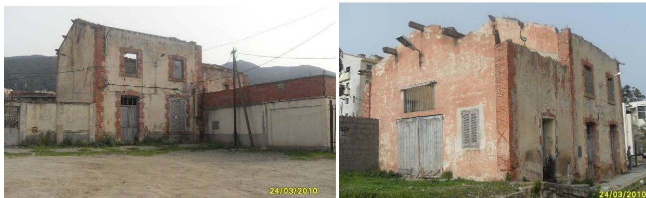
Figure 160 : Gare de Tadmaït, état de vestiges. Les façades côté cours (à gauche) et côté rails (à droite) [Source : Photo personnelle]
