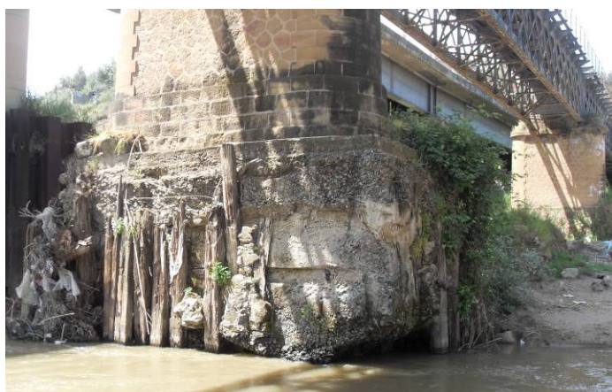
Figure 183 : Affouillement d'une pile. [Source : Photo personnelle]
