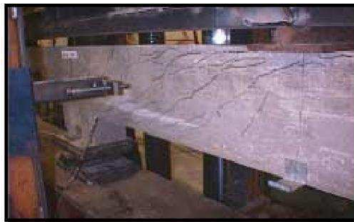
Figure I.15 : Mode de fissuration de la poutre CW1 ; Essais Khalifa et al [89].
