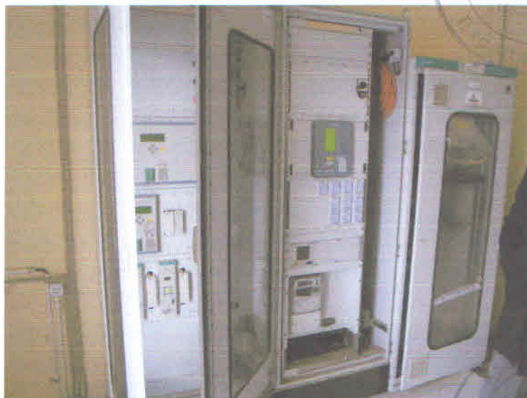
PHOTOS N°9 : vue sur l'armoire électrique endommagée
