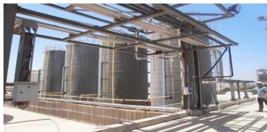
04 bacs de stockage eau de javel « Na Cl O
