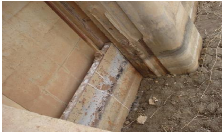
Figure I.9 : Blocage de la vanne de fond de la deuxième digue d'un barrage.
