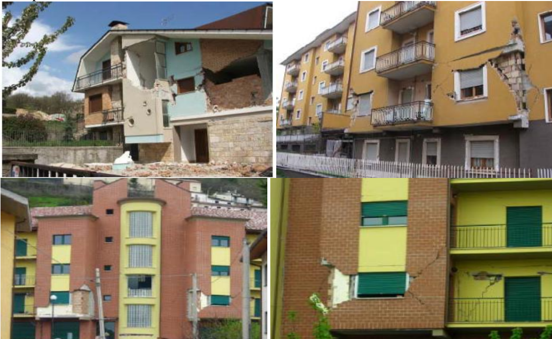
Figure I.25 : Effondrements des structures en béton armé, en maçonnerie, et des éléments non structuraux, séisme de l'Aquila (2009).
