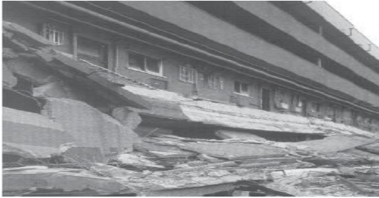
Figure I.23: Effondrement des coursives en porte-à-faux, séisme de Kobé, en Japon (1995).
