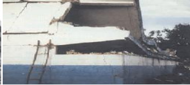
Figure I.24: Effondrement des poutres consoles en séisme de Cariaco en Venezuela (1997).
