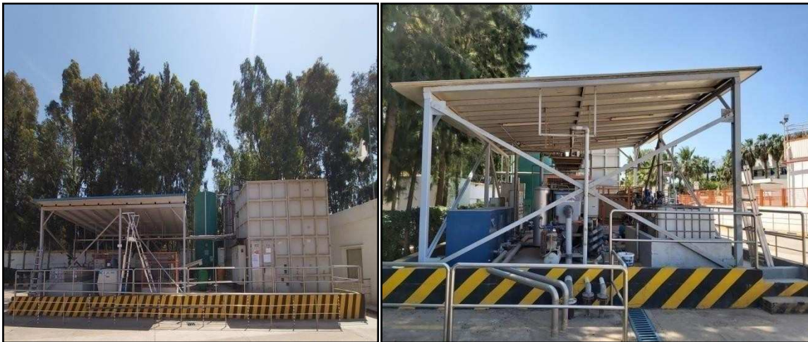
Figure 04 : Station de traitement des eaux usées
