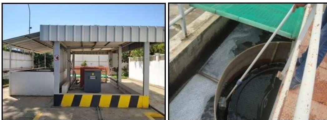
Figure 02: Station du traitement biologique
