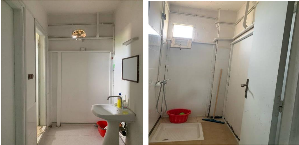
Figure III.10 : Les douches plombées.
