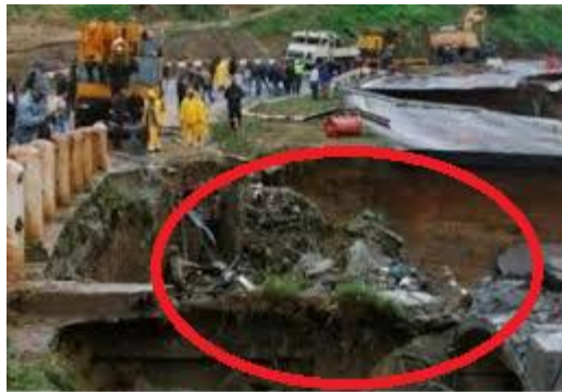
Figure II-20: endommagement des conduite en eau potable.
