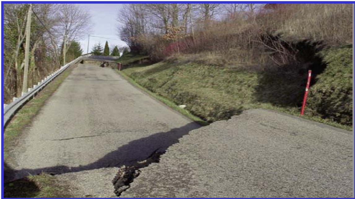
Figure I-3: Affaissement au niveau d'une route(cas réel).
