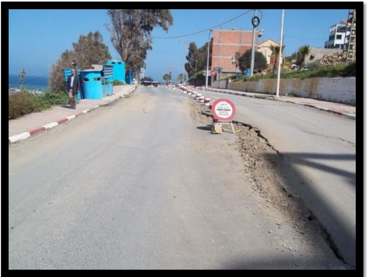
Figure III-16: arrachement sur chaussée dans le secteur ouest de la ville de Tizirt. (Source ANTEA-TTi-Hydro environnement).
