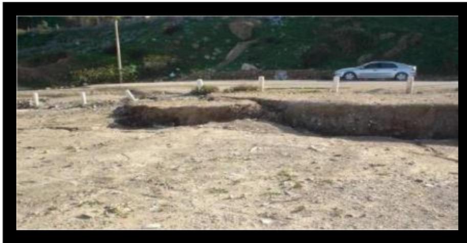
Photo II-17: Le glissement de la route des abattoirs.
