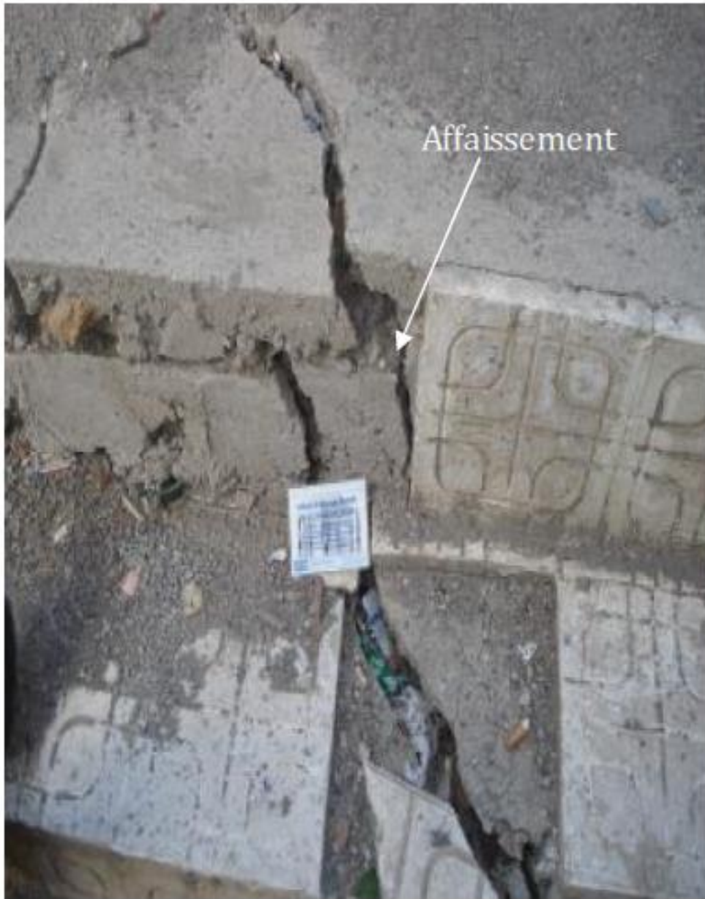
FigureII-24: affaissement du sol support du trottoir (source Djerbal, 2010)
