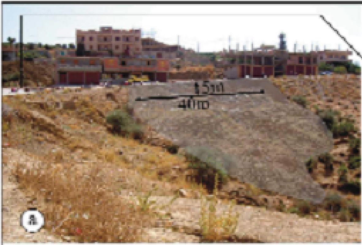
Figure II-15: vue depuis le nord-ouest sur le glissement du talus routier.
