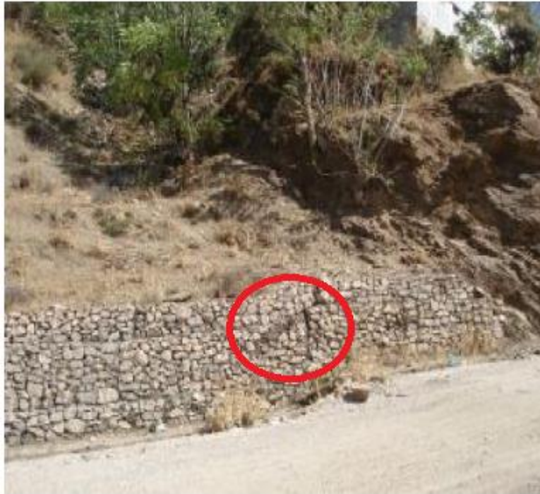
FigureII-21: fissuration et déstabilisation au niveau du gabionnage(source: Djerbal,2010)
