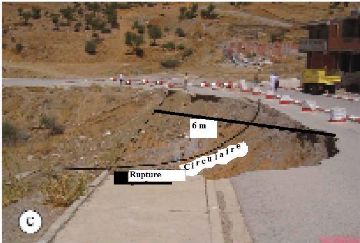
FigureII-16: (b) déformation et fissuration de la chaussée.
