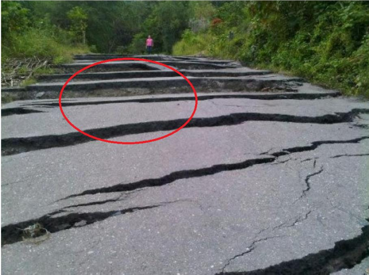
Figure II-9: dégradation d'une route suite au glissement de Venezuela (source: état de monde).
