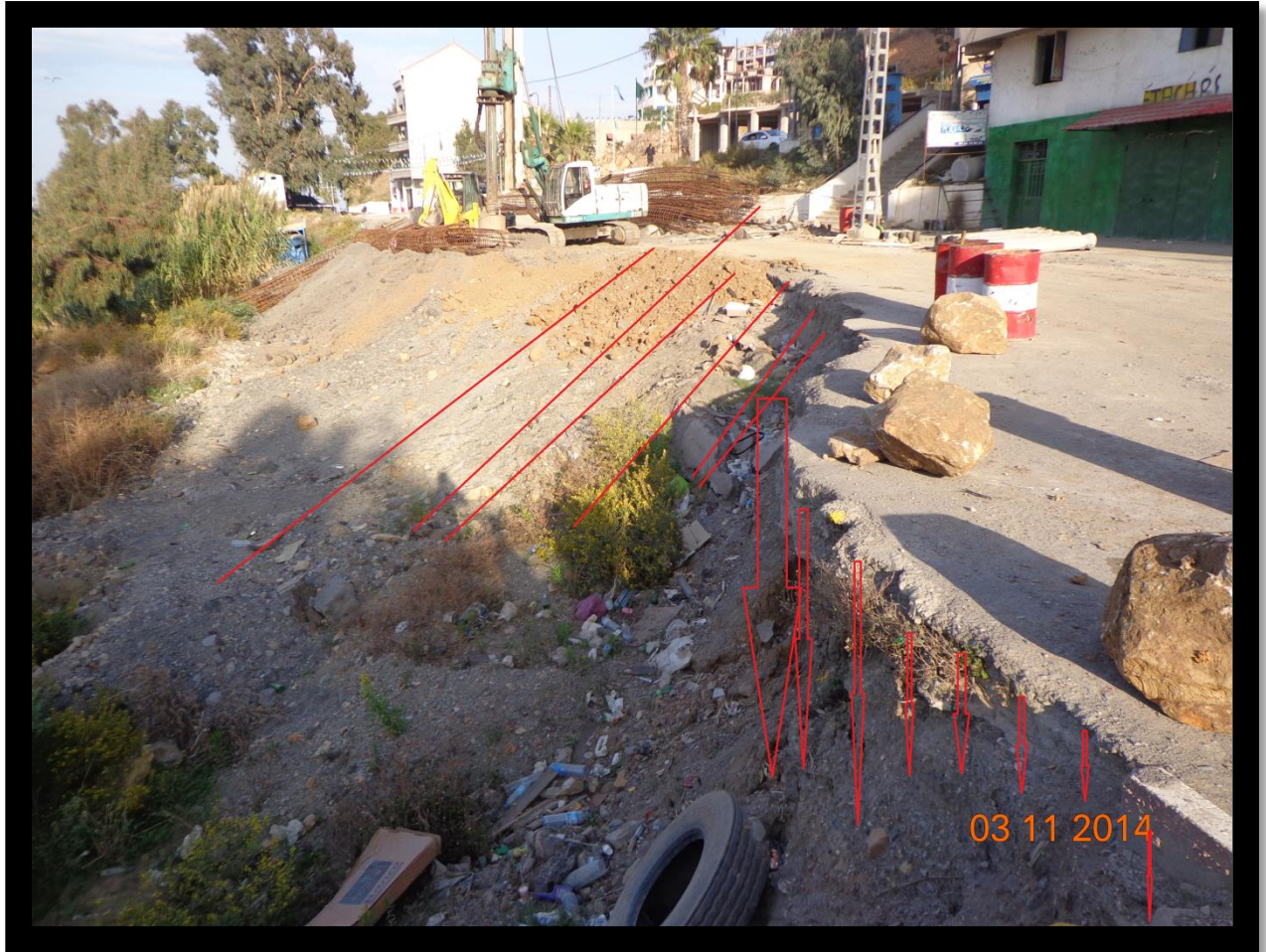
Figure III-17: affaissement au niveau de la route nationale N°24 (photo prise le 03 /11/2014).
