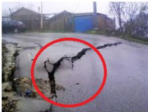
Figure II-18: affaissement considérable du sol support d'une chaussée.
