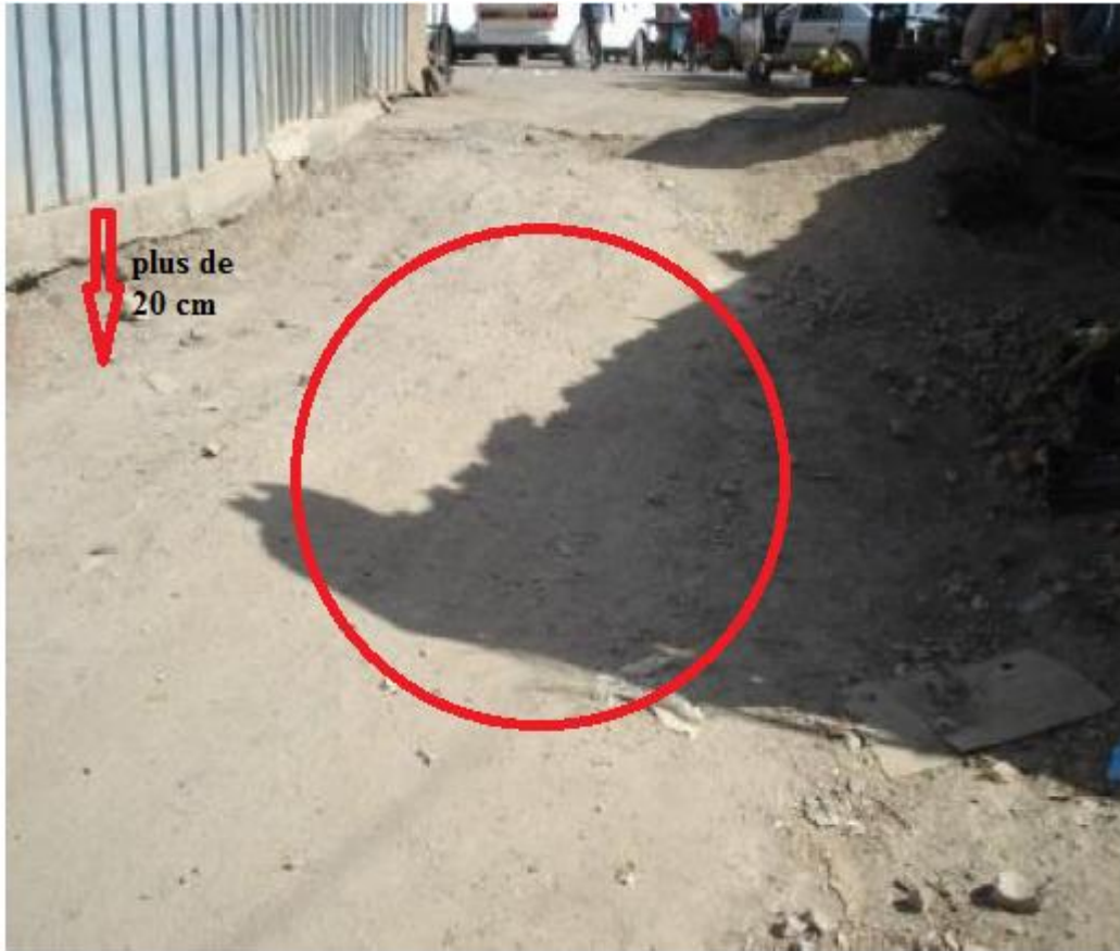
Figure II-25: affaissement du sol de marché (source: Djerbal,2010)
