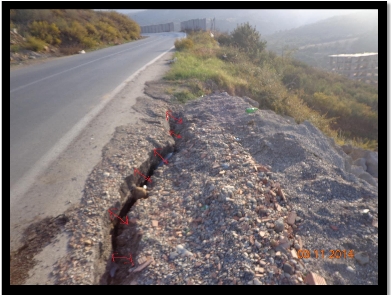
Figure III-19: apparition des fissures et affaissements de la RN°72 (Photo prise le 03/11/2014).
