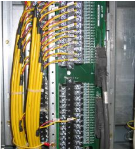
Entrées de thermocouples
