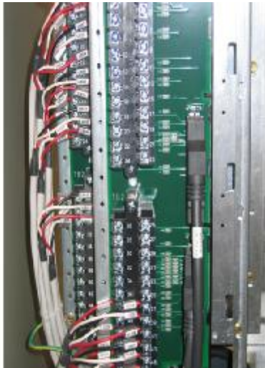
Entrées des RTDs
