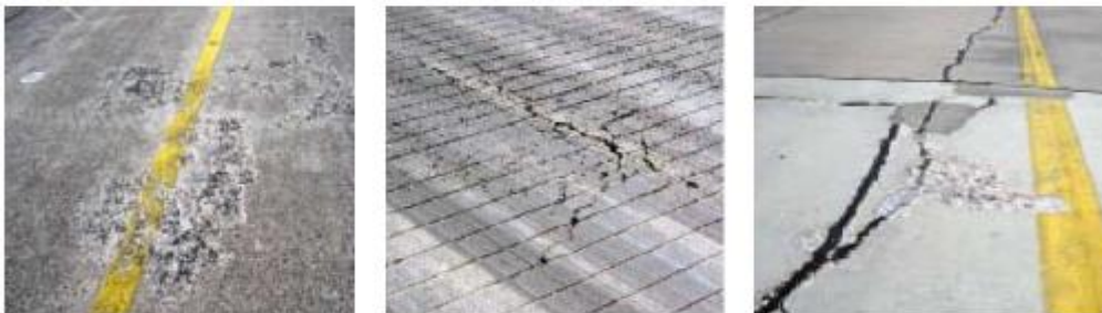
Figure 25 : le faïençage et l'écaillage dans des chaussées rigides [5]
