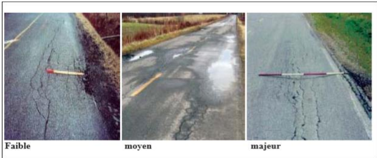
Figure 8 : Affaissements de la chaussée [4]
