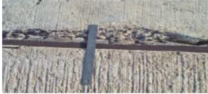
Figure 24 : Epaufre dans les chaussées rigides [5]
