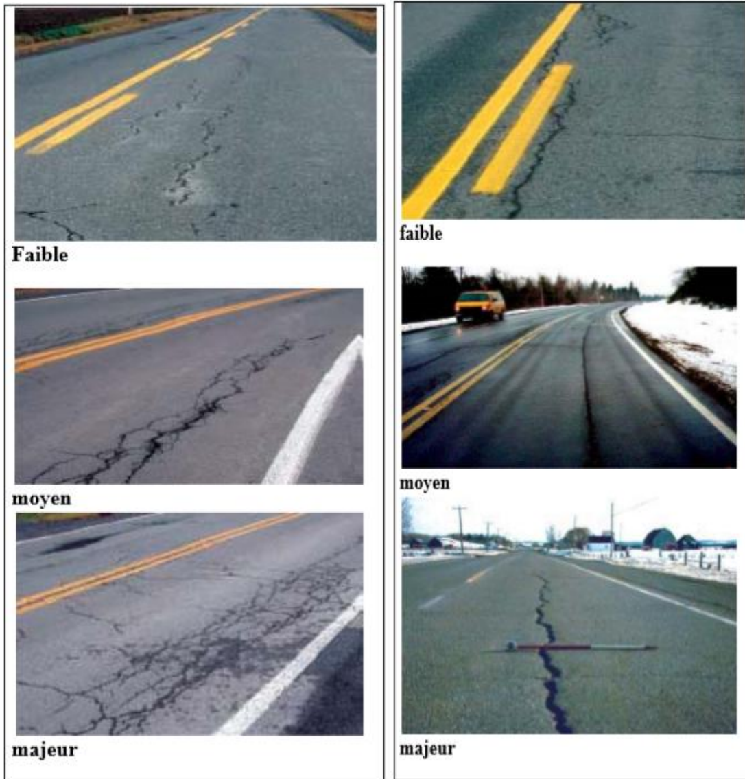
Figure 11 : Fissures longitudinales hors-piste de roues [4] Figure 12 : Fissures longitudinales en piste de roues [4]
