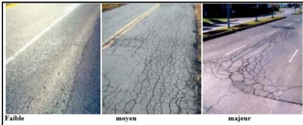
Figure 14 : Faïençage des chaussées [4]
