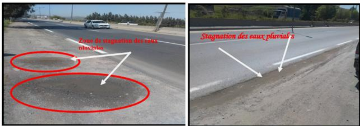
Figure 35 : Stagnations des eaux pluviales [11]
