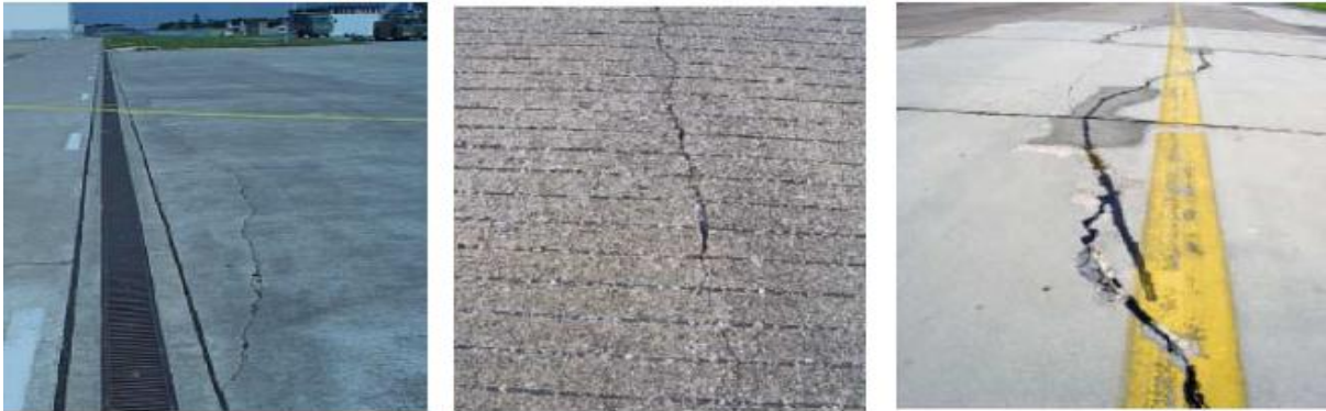
Figure 21 : fissure de chaussée rigide [5]
