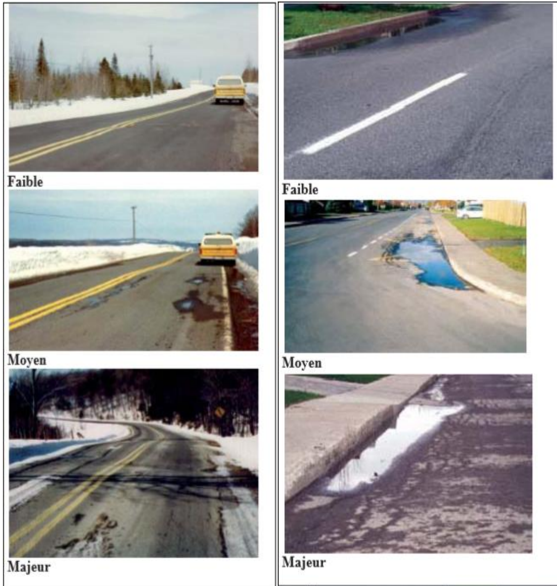
Figure 9 : Désordre du profil [4]
