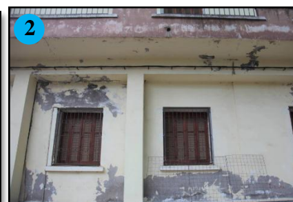
Fig 171 : Etat des murs extérieurs du bloc J. Source : Auteurs
