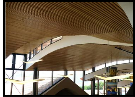
Figure148 : Faux plafond en bois www.belet-isolation.com
